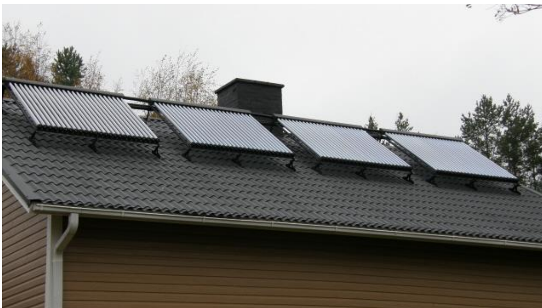
KUVA 7. Tyhjiöputkikeräimiä katolla. (Groundenergy.)
