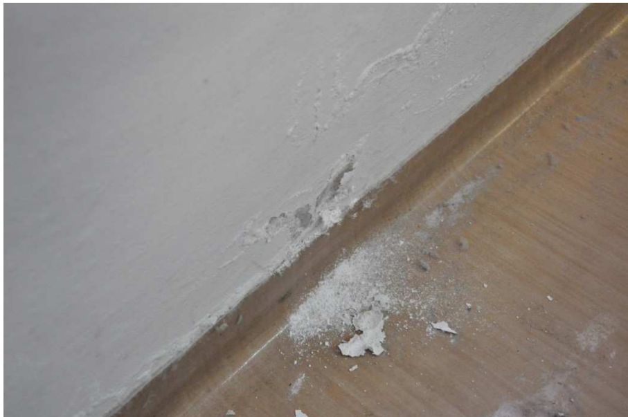
Kuva 8. Seinän betonisessa alaosassa maali hilseilee.
