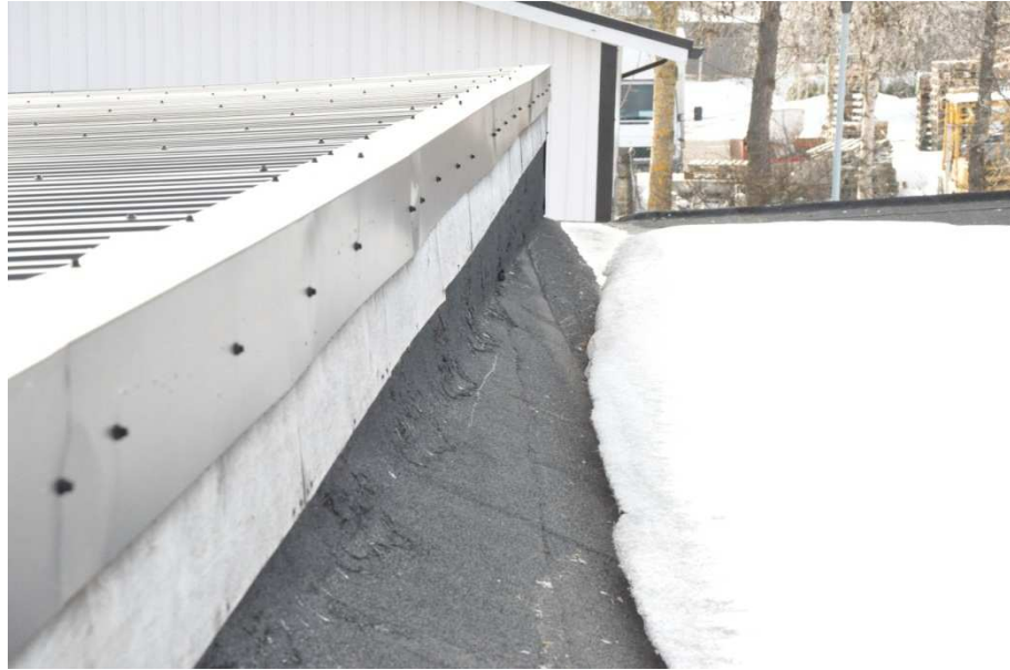
Kuva 5. Vanhemman ja uudemman osan liitoksessa huopakate on vaurioitunut ja puinen levytys kärsinyt.
