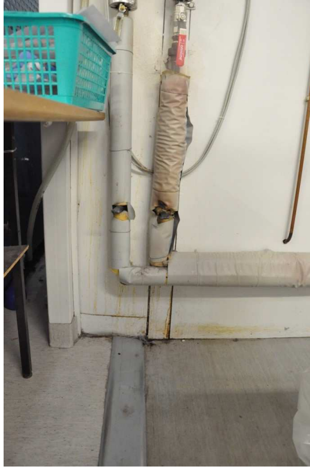
Kuva 9. Vesihöyryä vuotava putken liitos on kastellut seinää ja lattiaa. Seinälevy on vuotokohdasta selvästi kuprulla.
