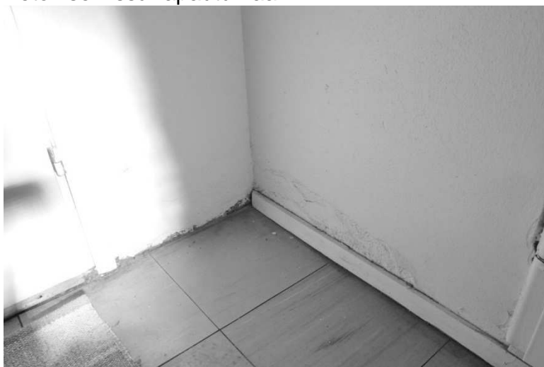
Muovilaatta lattiassa rikkoutunut, kosteus lattialla seinän vieressä 123 eli selvästi koholla.
