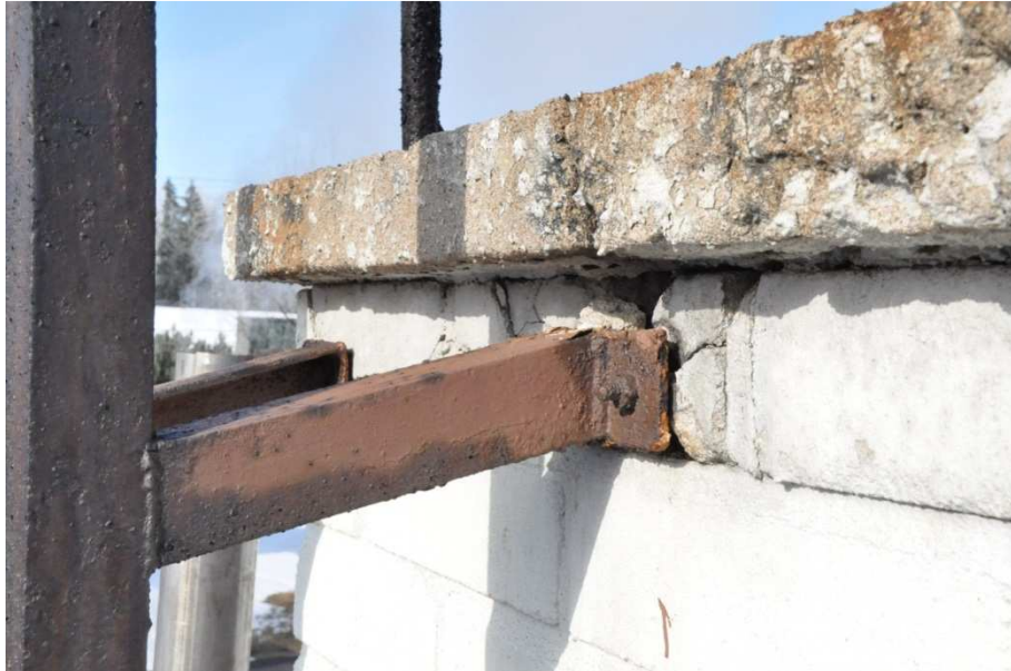
Kuva 6. Tikkaiden yläpään kiinnitystiili on pahoin rapautunut.
