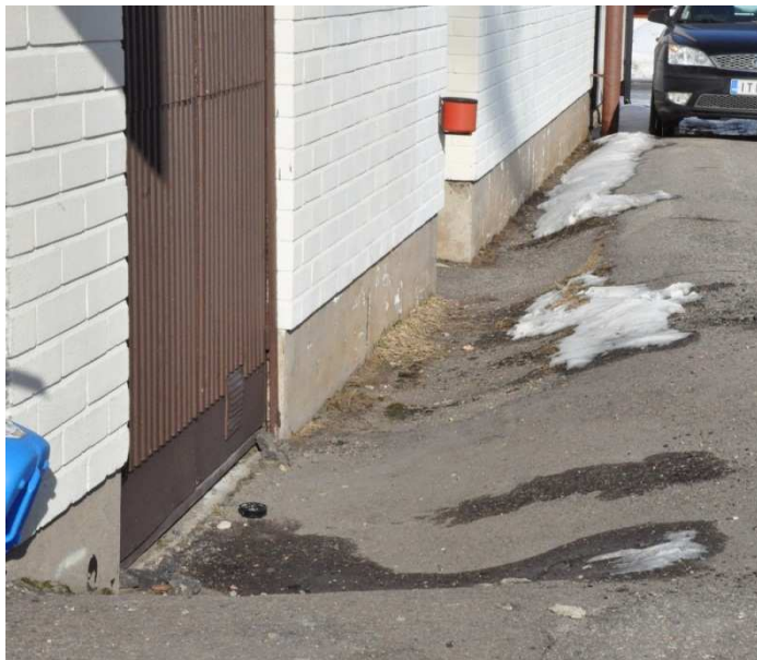
Kuva 2. Itäisellä seinustalla on jyrkkä vietto kohti rakennuksen seinää.
