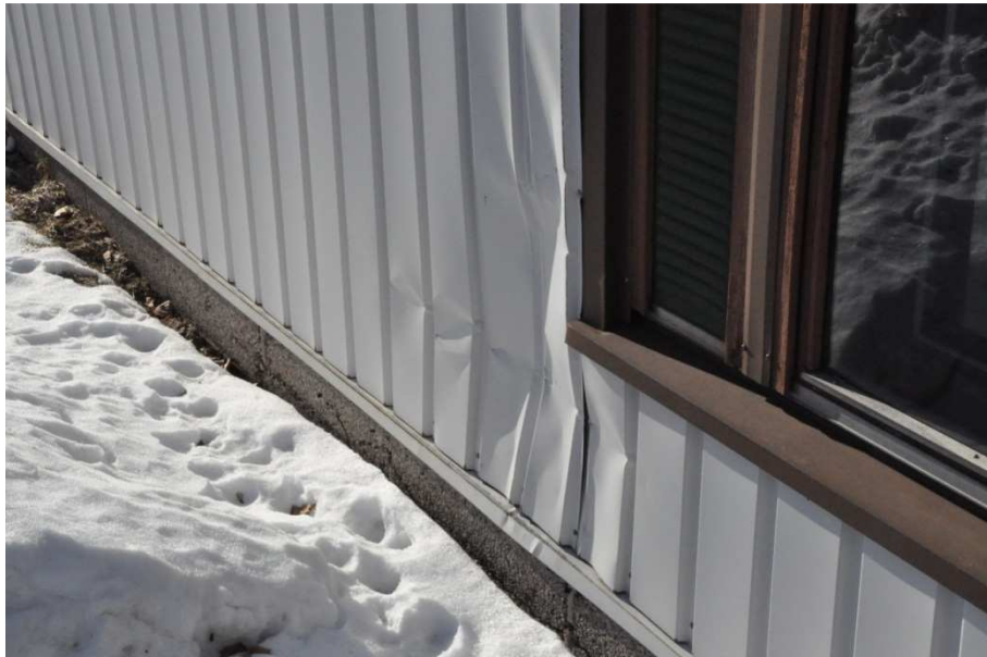
Kuva 3. Seinään on tullut isku, joka on aiheuttanut myös sisäpuolelle levyn halkeamisen.
