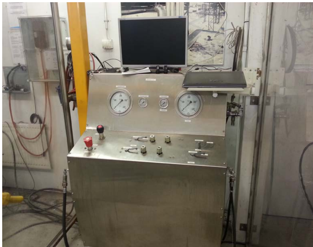
Kuva 1. YIT:n Rauman venttiilihuollon tietokone ohjatusta hydrauliyksiköstä säädetään varoventtiilin testauspaine.
