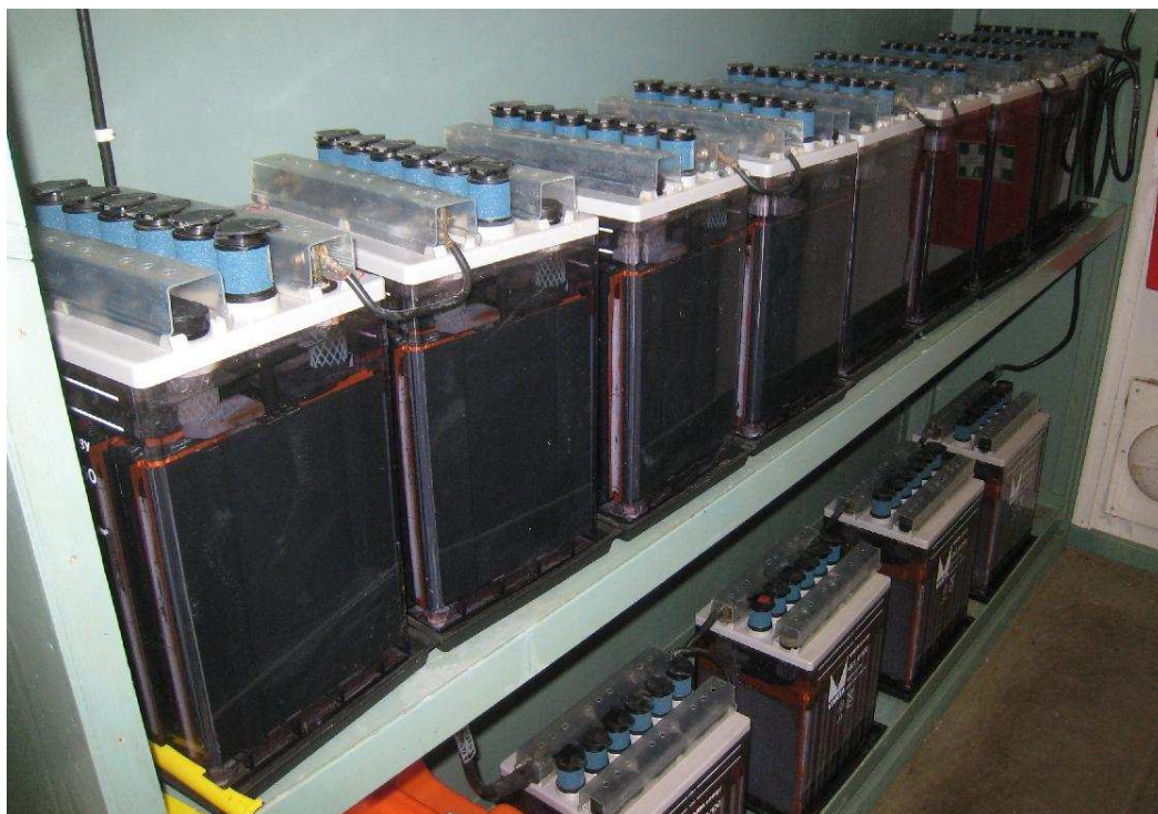
KUVA 13. Kytkinaseman varavoima-akusto. Ylhäällä 110V järjestelmä ja alhaalla 48V järjestelmä. (Jani Rissanen 2013.)
