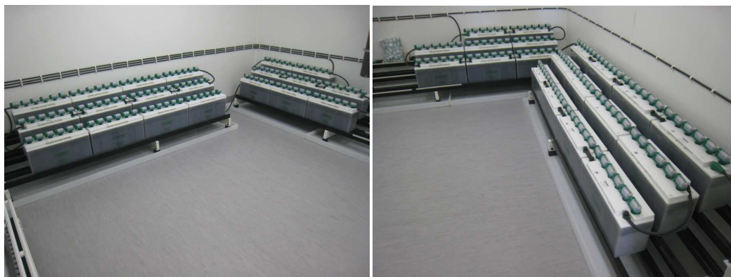
KUVA 9. UPS-järjestelmän lyijy-happoakusto Riijärvellä (Jani Rissanen 2013.)
