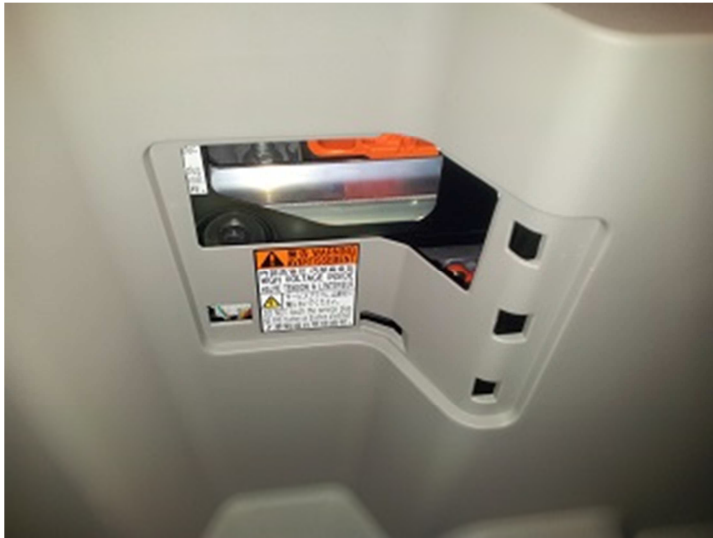
Kuva 18. Huoltoerottimen suojakansi aukaistuna takaluukussa
