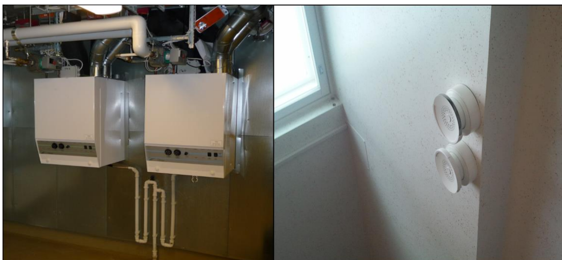
Kuva 5. Saunan ja porrashuoneen IV-koneet.
