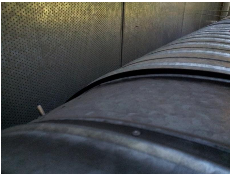
Kuva 16. G303:n kanaviston vuotokohta
