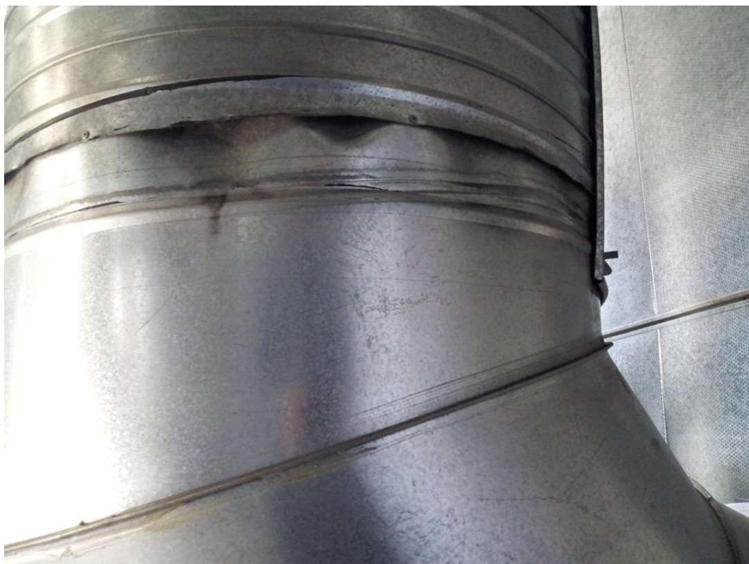
Kuva 4. Leppävaaran IV-kone G310:n vuotokohta
