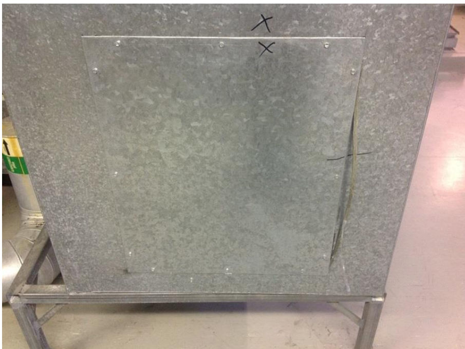
Kuva b) Leppävaara G303, kammion irtonainen tiiviste
