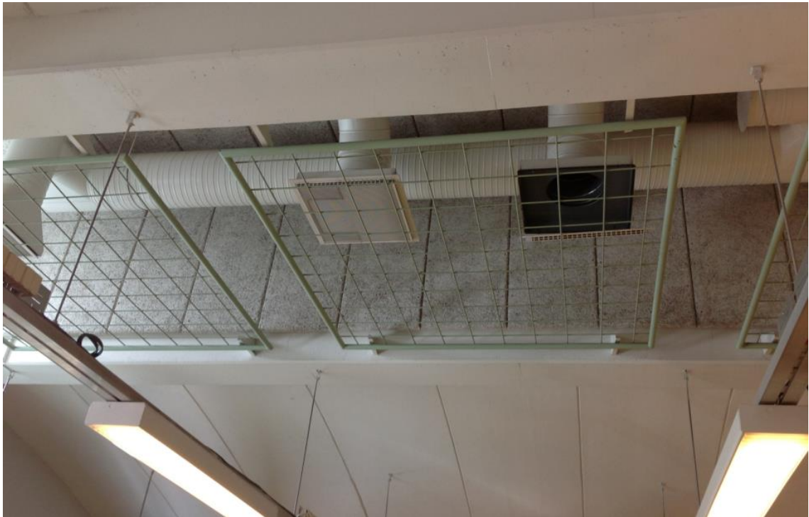
Kuva 11. Myyrmäen automaatiolaboratorion tuloilmalaitteet
