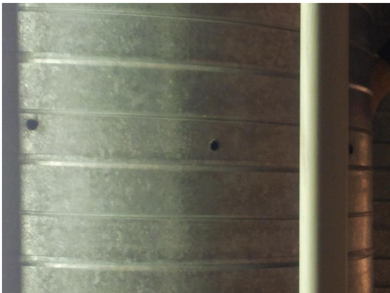
Kuva 15. Paikkaamattomia reikiä kanavassa
