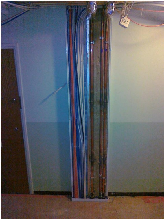
KUVA 6. Käyttövesilinja- ja sähkönousu porrashuoneessa
