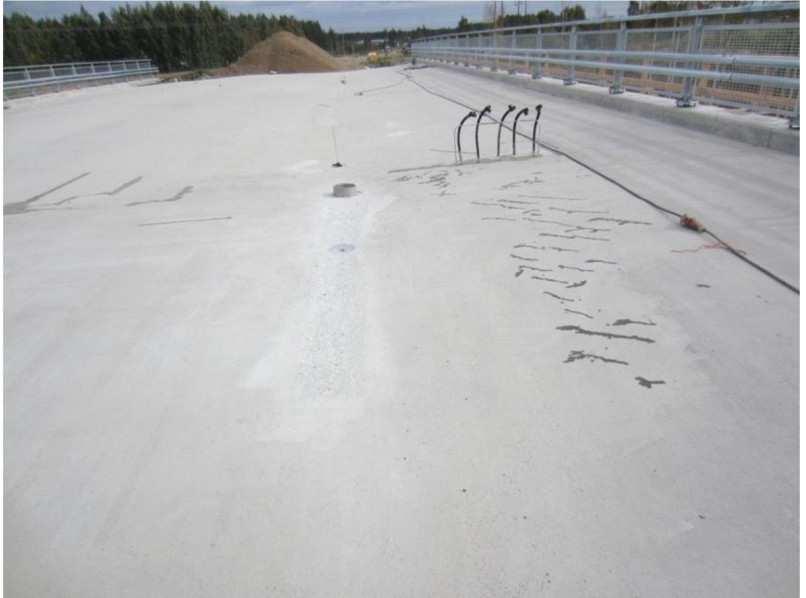
Kuva 3 Tasoitettu kohouma ja imeytettyjä halkeamia.
