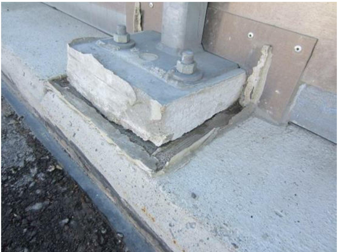
Kuva 24. Kaidepylvään juurivalu on irti kosketussuojaseinämän kohdalla. Valokuva Marko Savolainen 2013.
