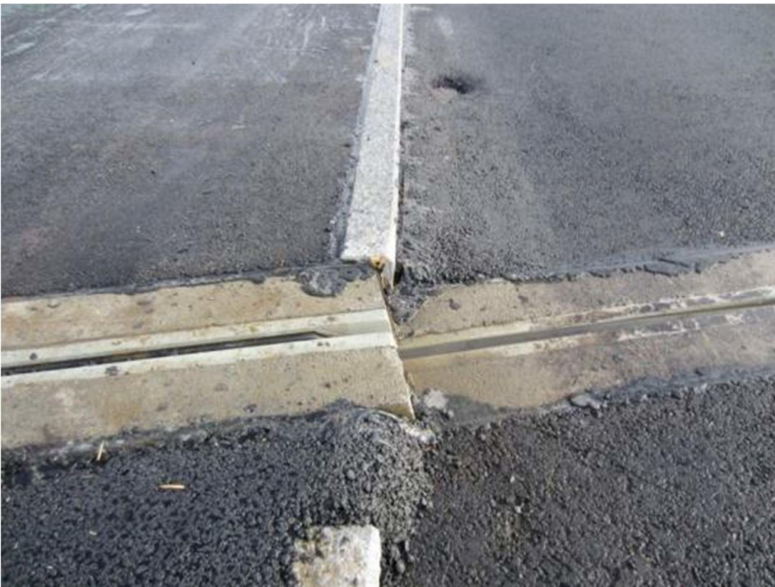
Kuva 28. Liikuntasaumalaitteessa ei ole huomioitu sillan vinoutta, jolloin kunnossapitokaluston törmäykset ovat todennäköisiä. Valokuva Marko Savolainen 2012.
