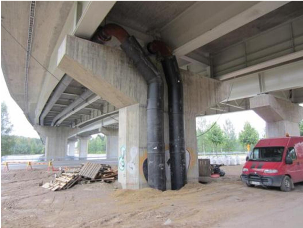
Kuva 6 Massiiviset kaukolämpöputket tuella T2.
