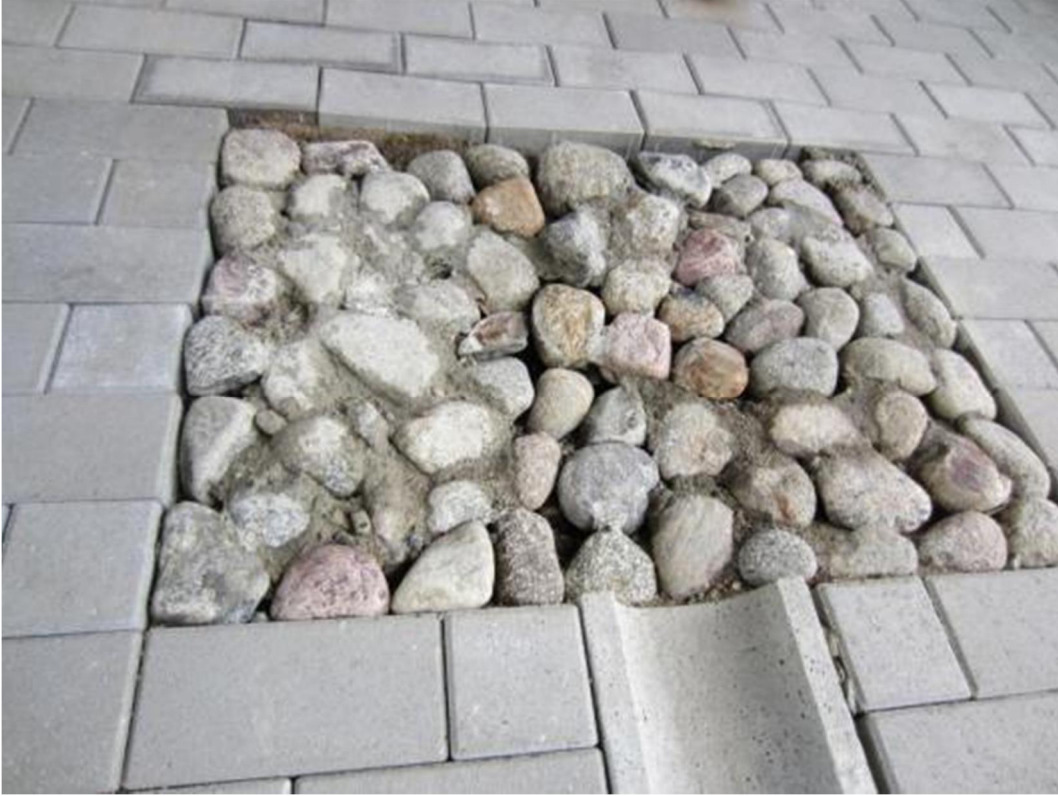
Kuva 14 Hulevesi pääsee kivipesästä verhouksen alle.
