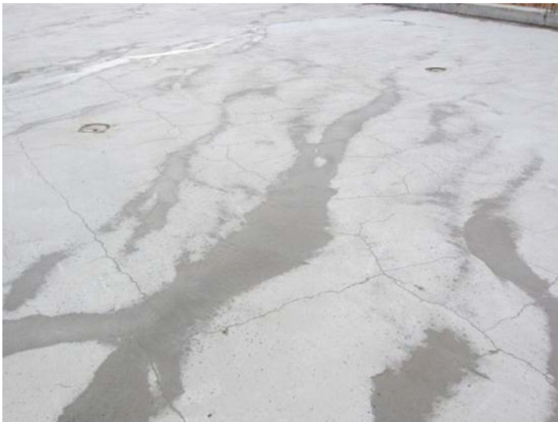
Kuva 9. Kannen yläpinnan imeytettäviä kutistumishalkeamia. Valokuva Marko Savolainen 2012.
