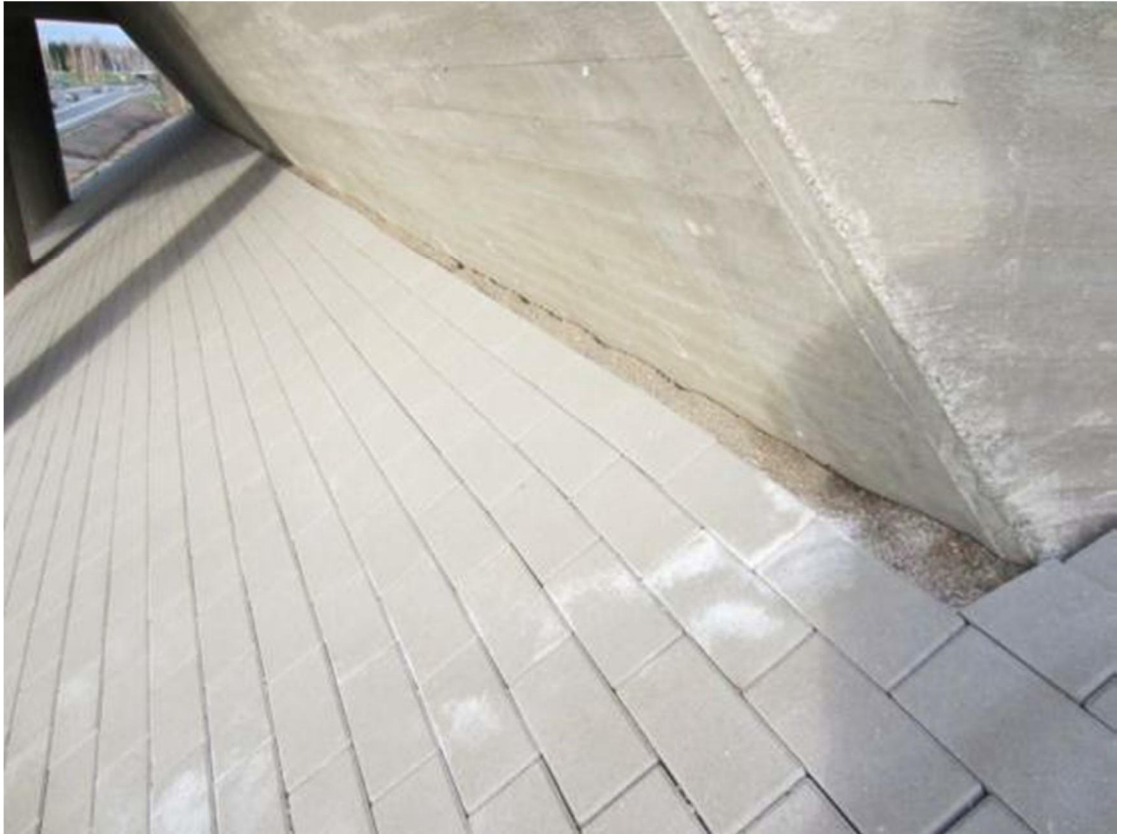
Kuva 32. Verhouksen ja sillan väli on jäänyt saumaamatta. Valokuva Marko Savolainen 2012.
