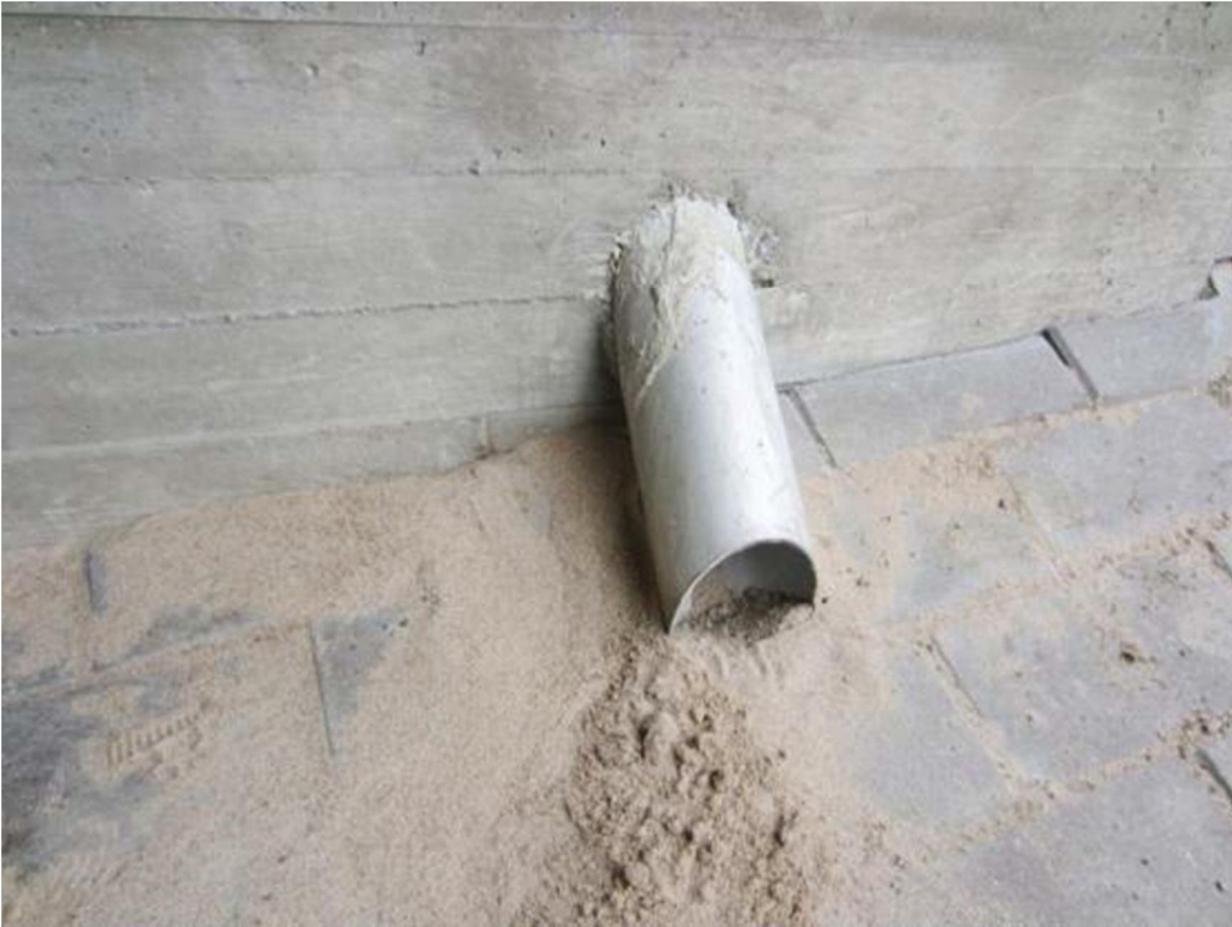
Kuva 29. Laakeritason vedenpoistoputki on sijoitettu väärälle korkeudelle. Valokuva Marko Savolainen 2012.
