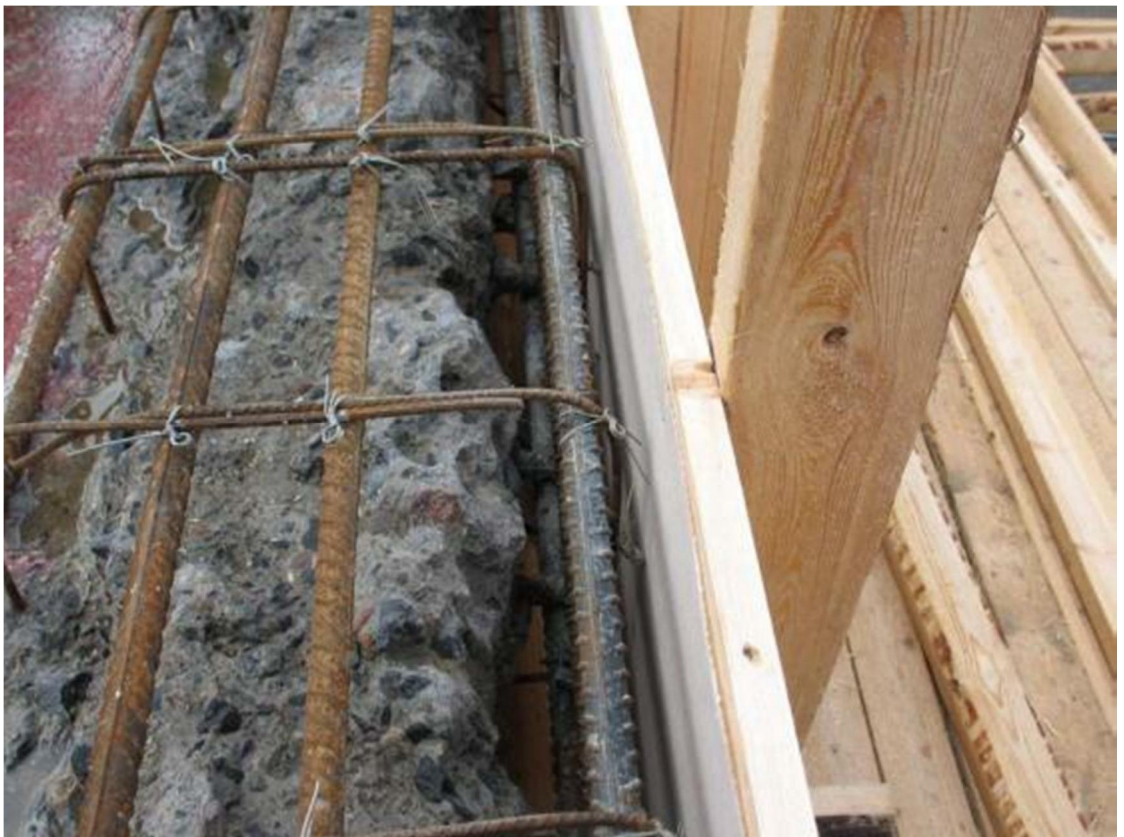
Kuva 6. Reunapalkin muotti on kiinni raudoituksessa, jolloin teräksiä suojaavan betonikerroksen paksuusvaatimus ei täyty. Valokuva Marko Savolainen 2011.
