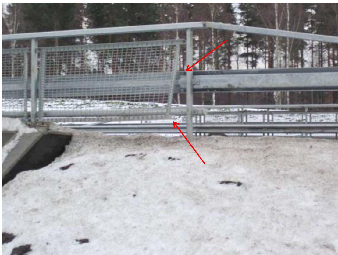
Kuva 22. Johteen U-tukipalkin pitäisi alkaa sillalta ja suojaverkko on irronnut. Valokuva Marko Savolainen 2011.
