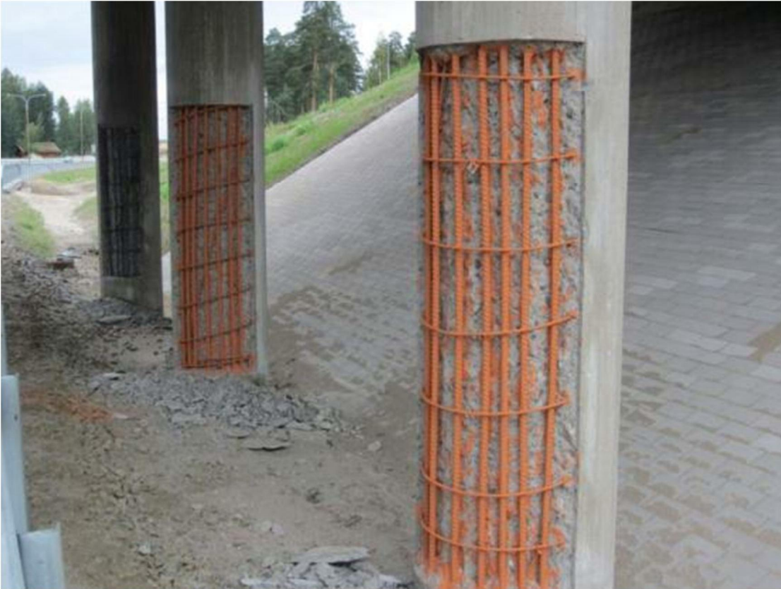
Kuva 20. Purkualueet on rajattu suoraviivaisesti ja teräkset on suojattu korroosiones-tomaalilla. Valokuva Marko Savolainen 2012.
