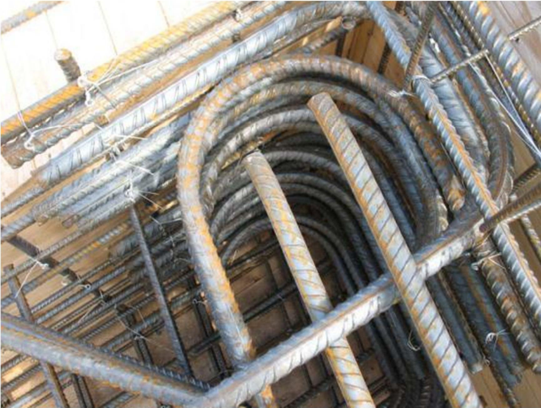
Kuva 4. Hyvin suunniteltu ja toteutettu kannen päätypalkin ja siipimuurin nurkan rauditus. Valokuva Marko Savolainen 2011.
