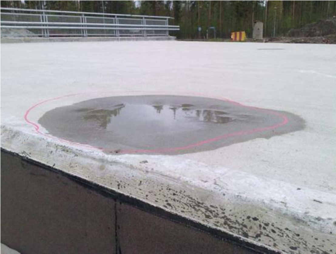
Kuva 8. Kannen yläpinnan lätäkkökohta on merkitty epoksi-hiekkapaikkausta varten. Valokuva Marko Savolainen 2011.
