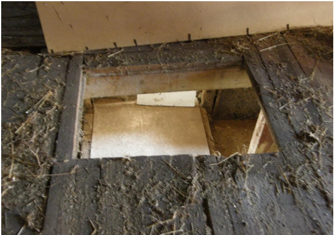
KUVIO 6. Navetan vintillä oleva suojaamaton heinien pudotusluukku on vaarallinen
