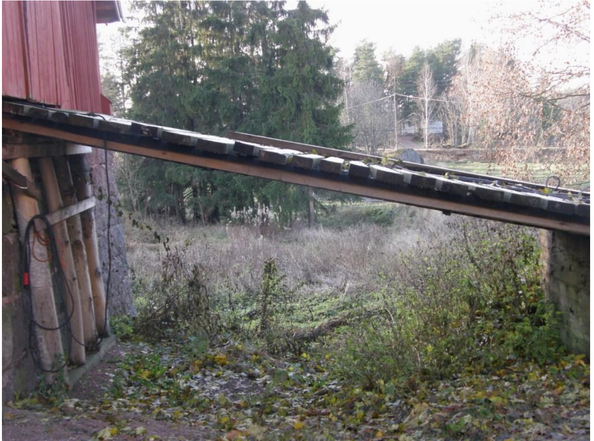
KUVIO 3. Navetan vintille johtava ajosilta, josta puuttuvat suojakaiteet
