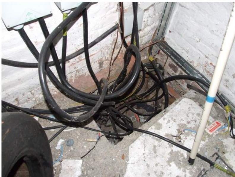
KUVA 12. Syöttökaapeleiden jatkokset, (valokuva Timo Nikula.)
