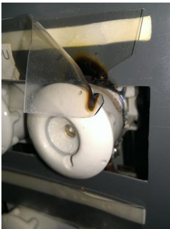
KUVA 5. Keskuksen kosketussuojaus, (valokuva Timo Nikula.)
