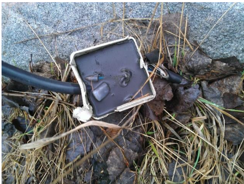
KUVA 18. Varastorakennuksen syöttökaapelinjatkos, (valokuva Timo Nikula.)
