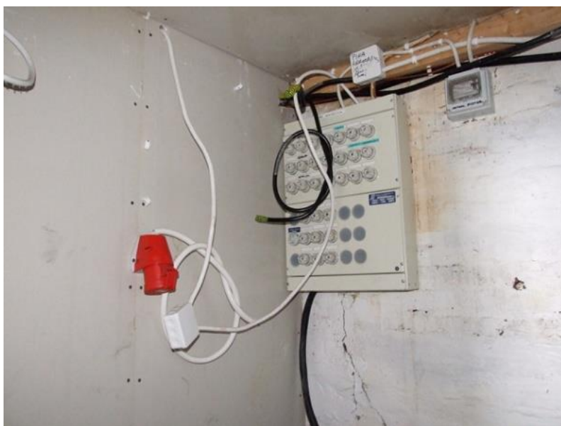
KUVA 13. Vanhan pääkeskustilan asennuksia, (valokuva Timo Nikula.)
