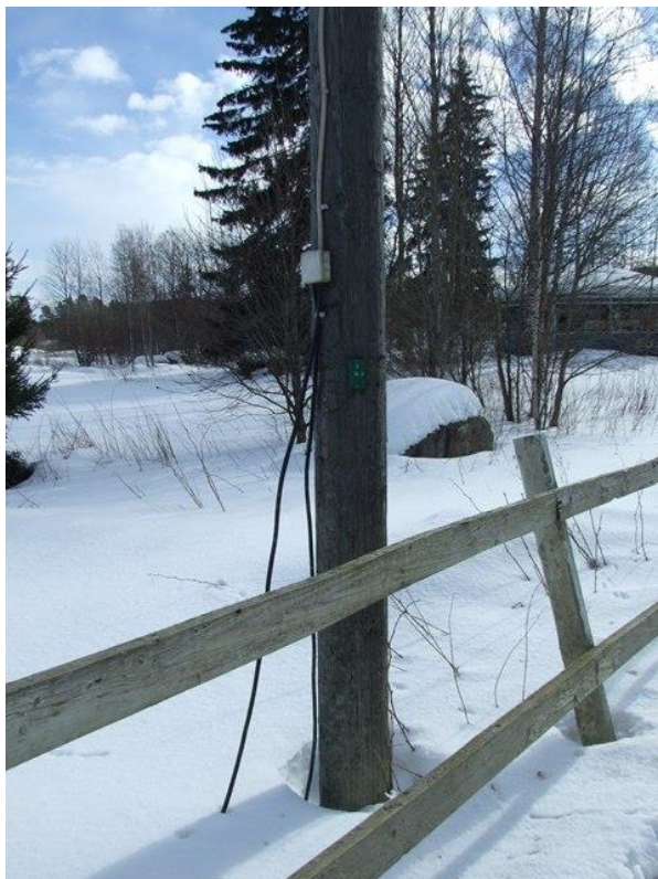
KUVA 10. Valaisinpylvään syöttökaapelit ilman suojakourua, (valokuva Timo Nikula.)
