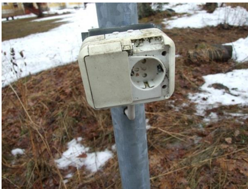
KUVA 9. Valaisinpylväeseen asennettu pistorasia, (valokuva Timo Nikula.)
