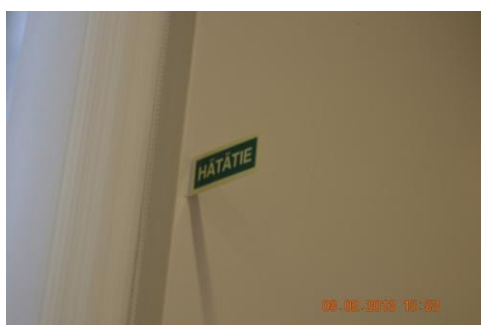
Kuva 39. Laboratorion hätäpoistumisreitit merkintä
