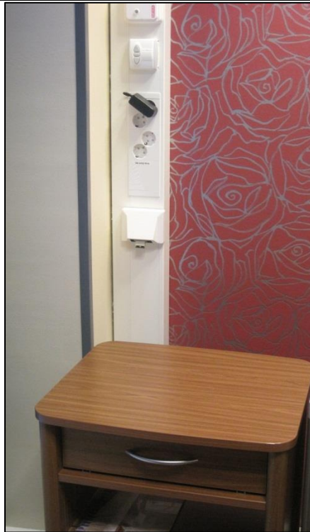
Kuva 21. Pistorasiat sijoitettu korkeammalle (kaluste edessä hankaloittaa käyttöä, mutta on siirrettävissä)
