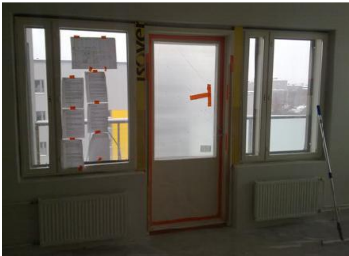
Kuva 7. Ikkunoiden ja ovien säätämisiä joudutaan usein suorittamaan jälkikäteen.
