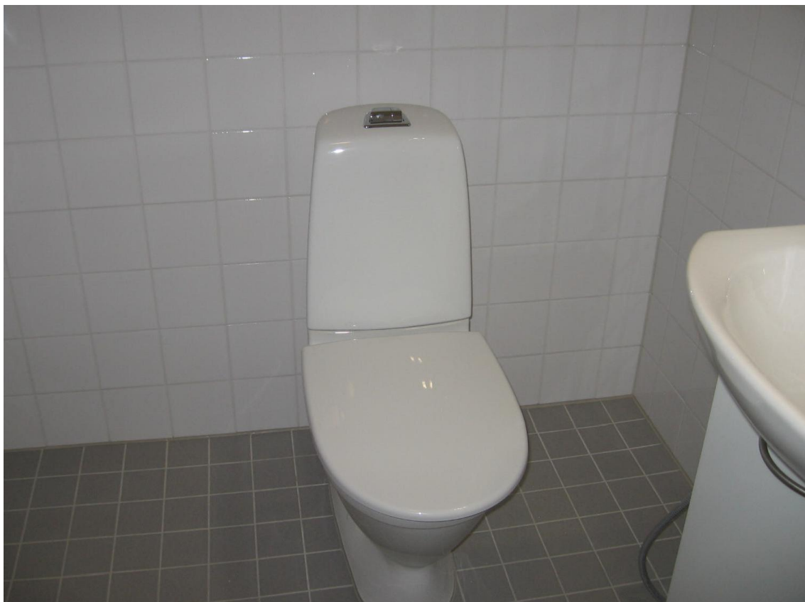
Kuva 10. Lattialaatoituksista saattaa aiheutua jälkitöitä.
