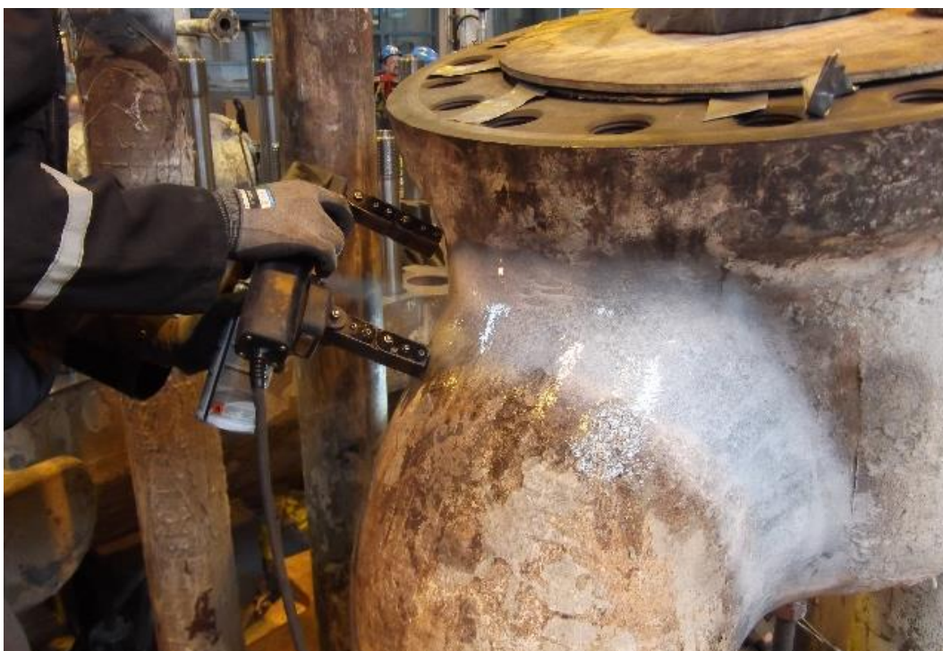
Kuva 17. Magneettijauhetarkastus tulohöyryputken jatkokohdan hitsaussaumasta ennen pikasulkuventtiiliä.
