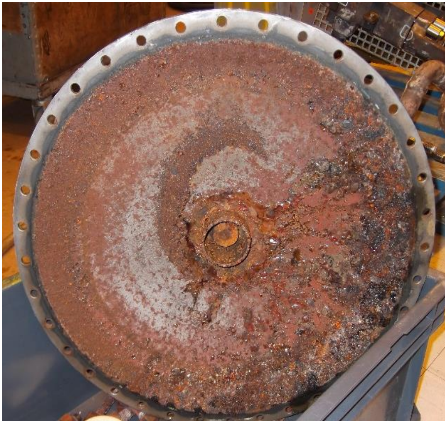
Kuva 13. Vuotohöyryn säätöventtiilillä korroosiota, joka on puhdistettava revision yhteydessä.
