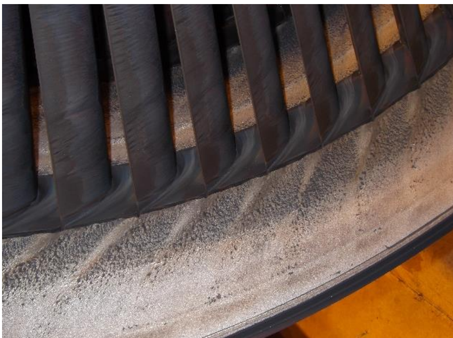
Kuva 14. Eroosiokorroosiota matalapainepuolella johtosiipikannattimessa. Höyryn kastepiste on päässyt laskemaan kastepisteen alapuolella. Höyryvirtaan muodostuneet lauhdepisarat ovat aiheuttaneet johtosiipikannattimessa näkyvät kulumisvauriot.
