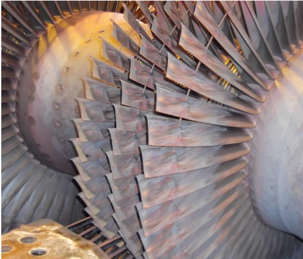
Kuva 11. Roottorin siipiin kertynyttä likaa, joka huonontaa turbiinin hyötysuhdetta ja edesauttaa korroosion syntymistä.
