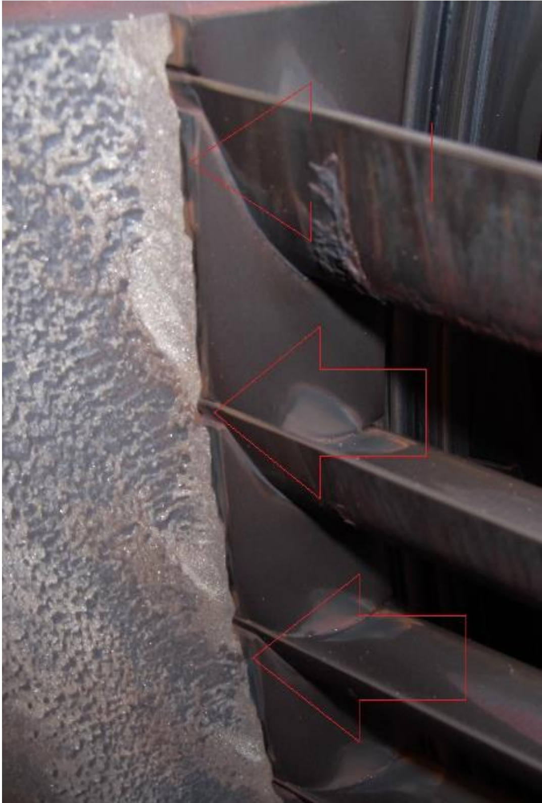
Kuva 15. Visuaalisessa tarkastuksessa löydetty kosteuden aiheuttamaa eroosiotakorroosiota johtosiipikannattimessa.
