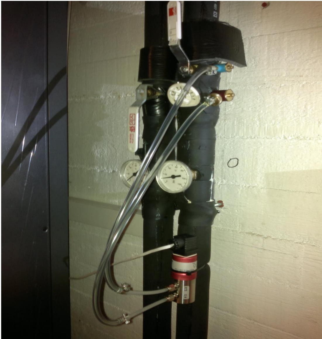
Kuva 12. Sähköinen paine-erolähetin kytkettynä ilmastointikaappikoneen linjasäätö-venttiiliin.
