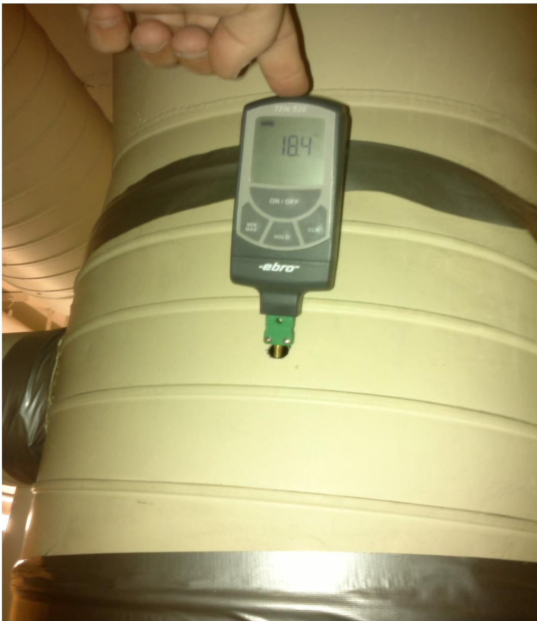
Kuva 15. Lämpötilan mittaus tuloilmakanavasta
