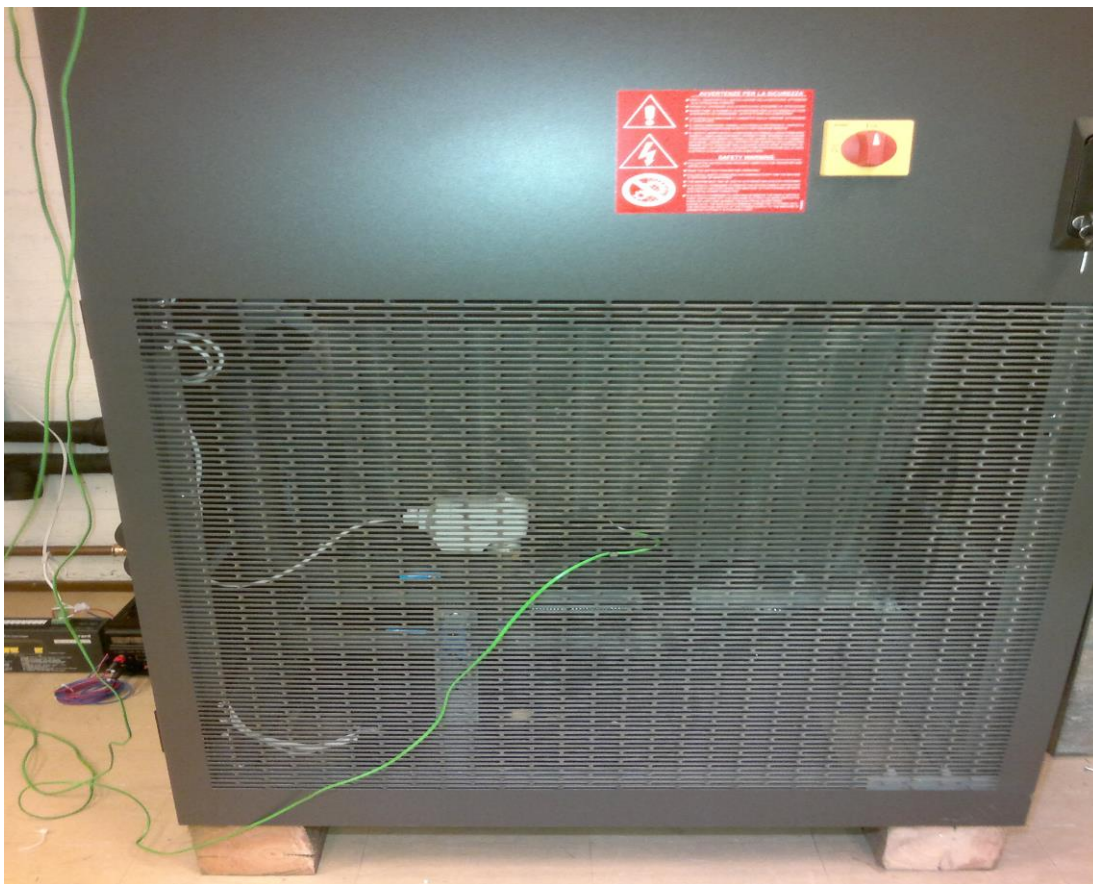
Kuva 8. K-typin termopari mittaamassa kaappikoneen imuilman lämpötilaa
