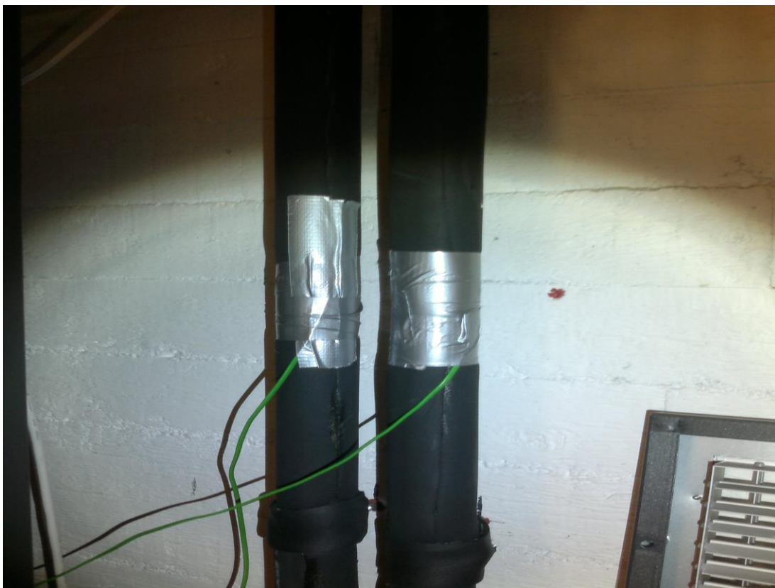
Kuva 9. K-tyypin termoparit mittaamassa jäähdytyspatterin vesi-etyleeniglykolipiirin lämpötilaa meno- ja paluuputkesta
