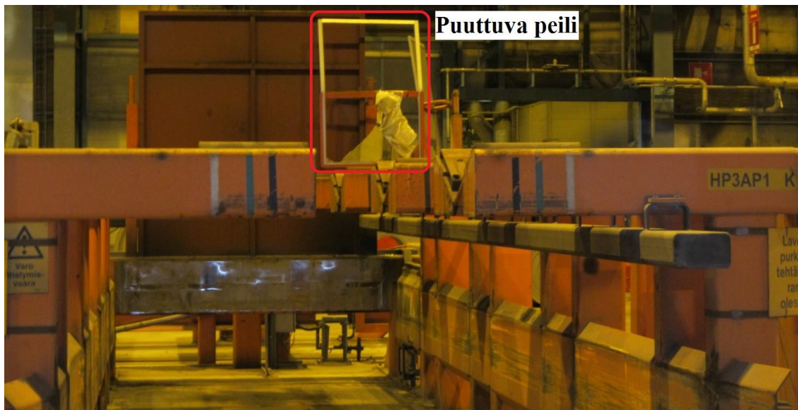
Kuva 6. Puuttuva peili HP3-linjan lavettiramppilla
