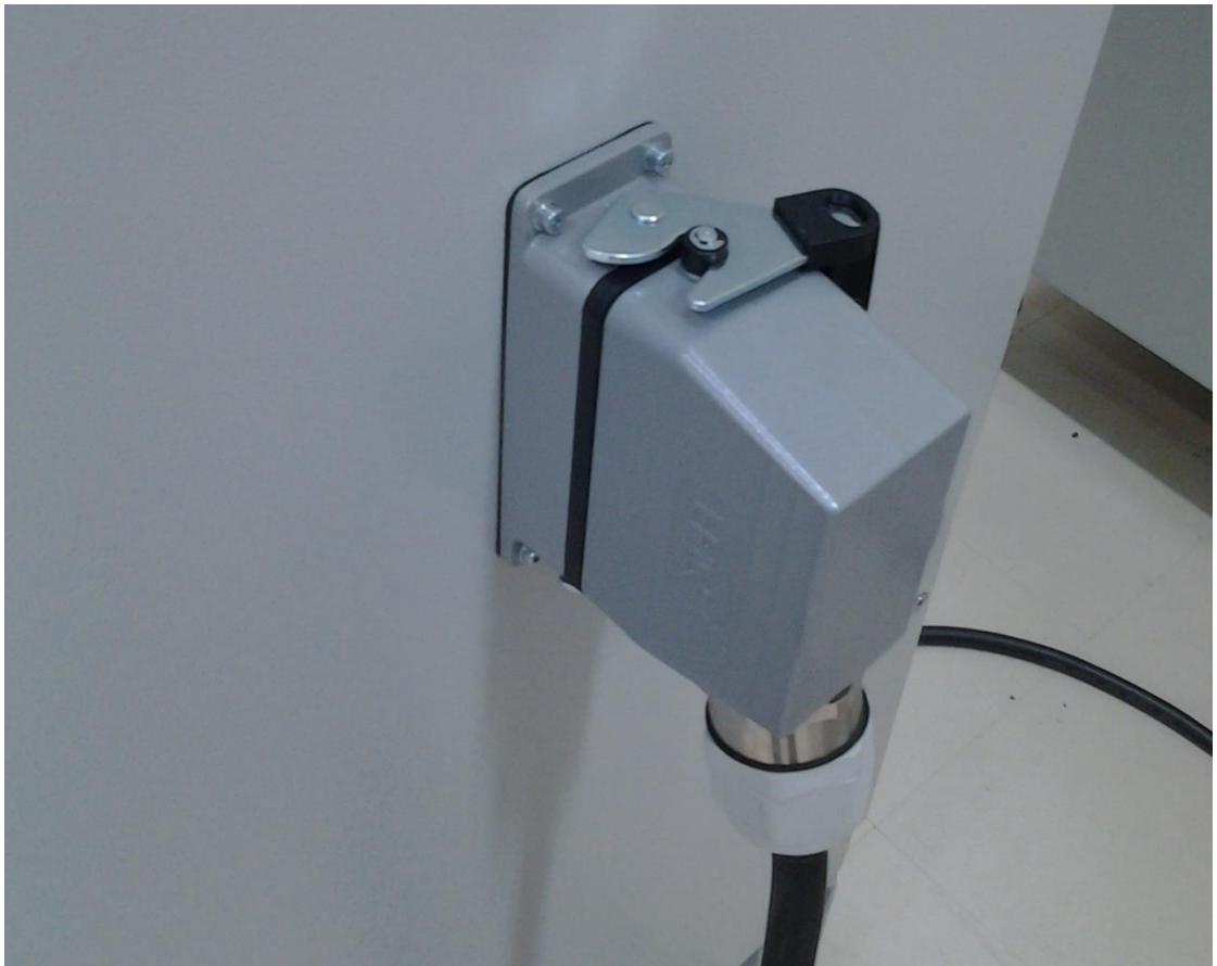
Kuvio 13. Syöttökaapelin kytkentään käytetty liitin
