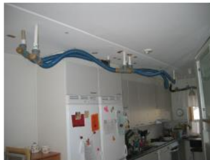
Kuva 1 Keittiön katon kuivausputkistoa. HUOM! Reikien määrä.
