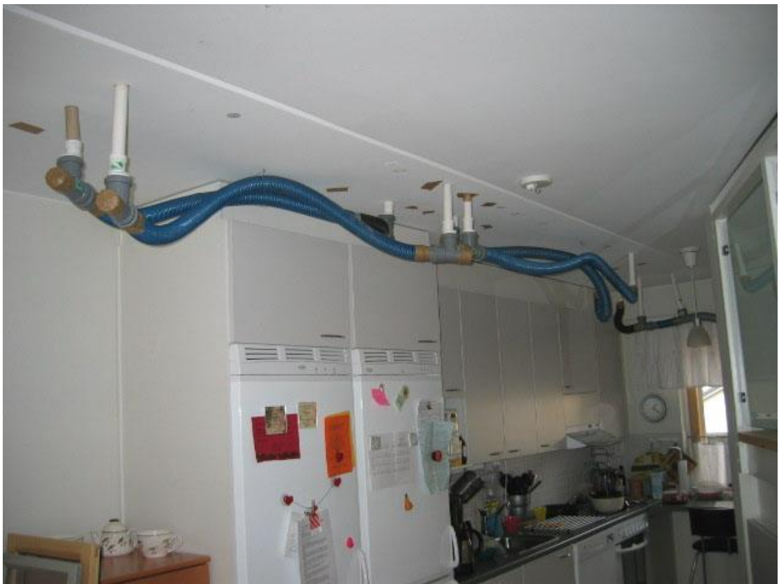
Kuva 7. Onteloihin joudutaan tekemään useita reikiä onteloiden kuivattamiseksi. [8, s.1]
