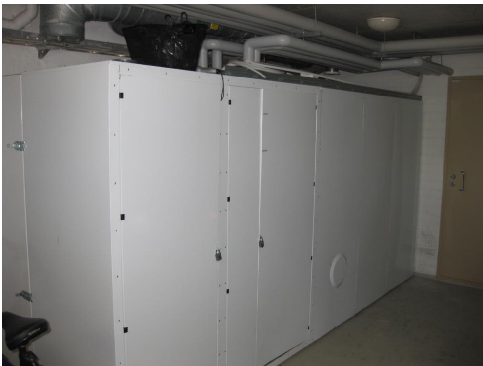
KUVA 4. Sisäyksikkö sijoitettuna polkupyörävarastoon.
