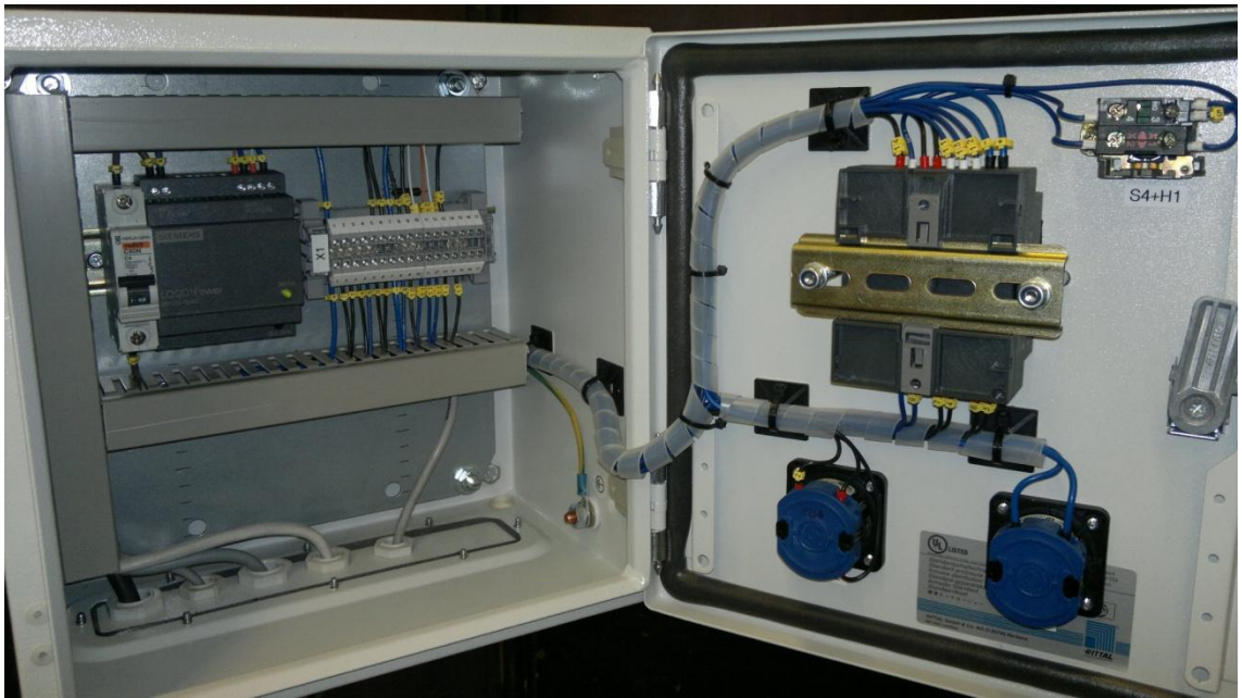
KUVA 10. Valokuva ohjauskaapin OK01 sisältä (Kuva: Janne Isomettä 2013)
