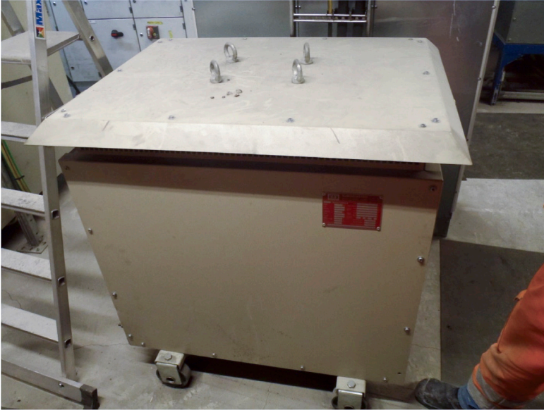
Kuva 14. Maan alla käytettävä 20/0,69 kV muuntaja. (kuva Jaakko Etto 2013)
