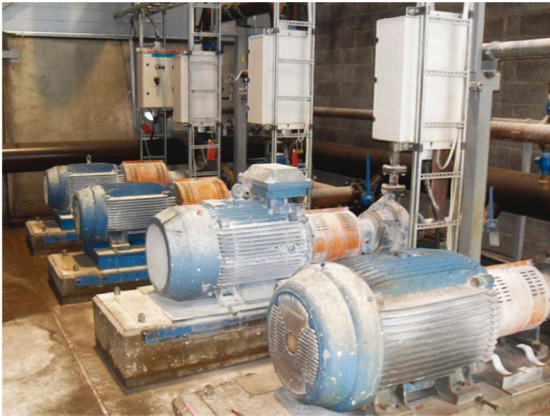
Kuva 2a. Ennako-odotuksia Kittilän kaivoksesta opinnäytetyön pohjalta, prosessin sähkömoottorikäyttöjen olosuhteet./3/
