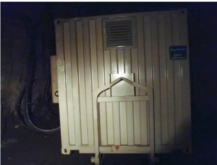
Kuva 15. Tyypillinen kontti, johon maan alla on sijoitettu 20 kV kojeisto, muuntajat, pienjännitekeskukset, UPS järjestelmät, automaatiokaapit ja apusähköjärjestelmät. (kuva Jaakko Etto 2013)
