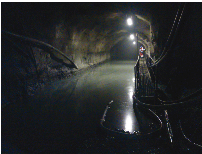
Kuva 8. Perässä hieman tulvii, laitevian aiheuttamaa paikallista veden korkeuden nousua. (kuva Kimmo Keltamäki 2013)
