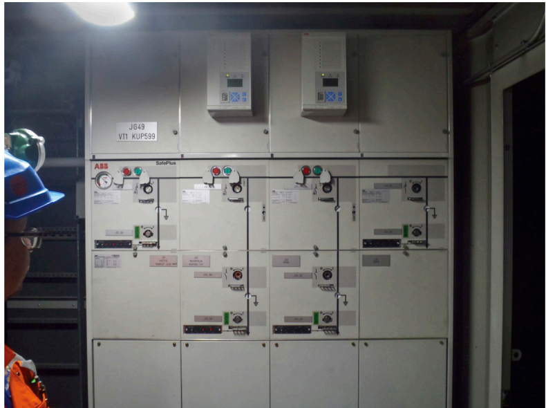
Kuva 12. Tyypillinen 20 kV keskijännitekojeisto. [kuva Jaakko Etto 2013]
