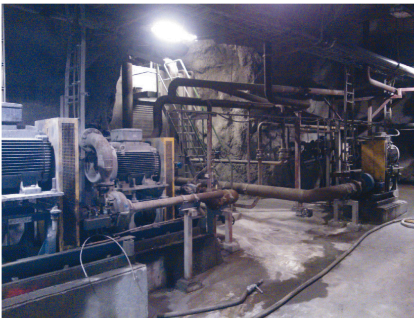
Kuva 7. Vedenpumppauslaitteistoa maanalaisessa kaivoksessa. (kuva Kimmo Keltamäki 2013)
