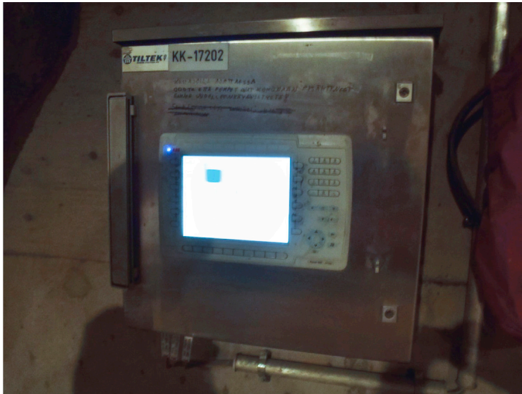
Kuva 16. Maanalaisen kaivoksen ohjauspiste (veden pumppaus). (kuva Jaakko Etto)
