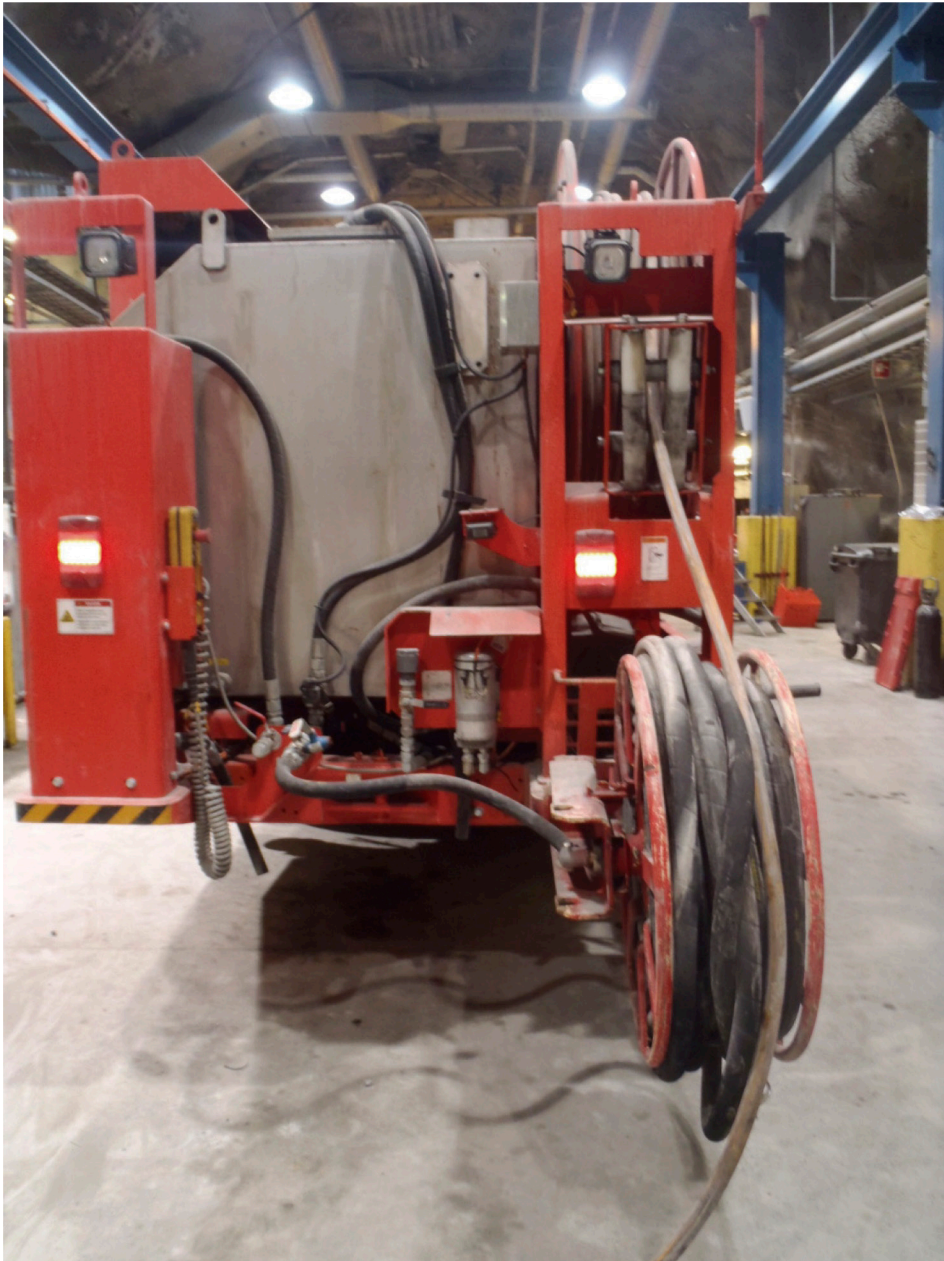
Kuva 11. Liikuteltavan työkoneen sähköliityntä. Kaivosten työkoneissa yleisesti CAN ohjausväylä, jolla työkoneen ohjaukset toteutetaan. 400V tai 690 V sähköliityntä sähkökoneille ja pistokeliityntä varmistettu. (kuva Jaakko Etto 2013)
