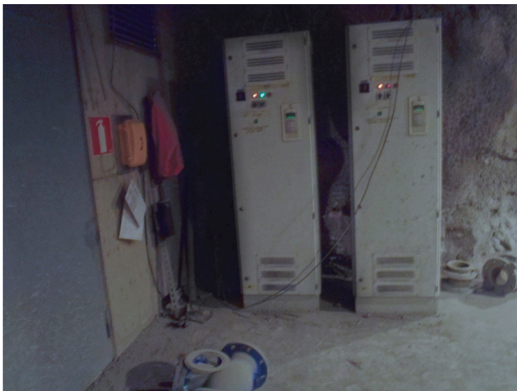
Kuva 17. Maanalaiseen kaivoskäytävään asennettuja pumppujen taajuusmuuttajakäyttöjä, kuva on otettu vianetsintätilanteessa Kittilässä noin tasolla -300. (kuva Jaakko Etto 2013)
