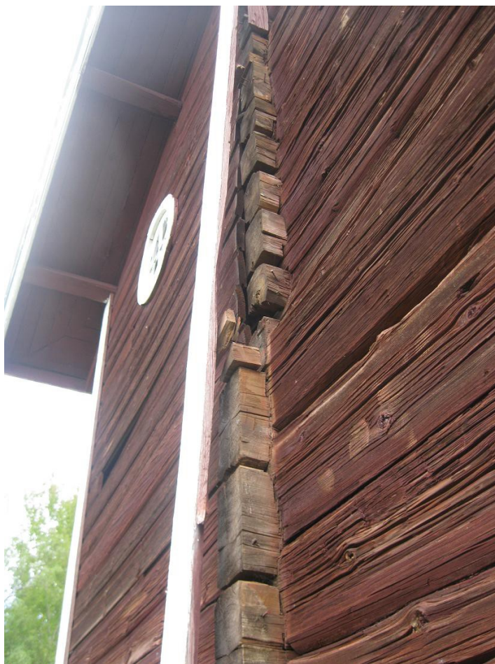
Kuvio 1: Leivintuvan ja liiterin välinen liikkunut seinärakenne sekä pettänyt nurkkasalvos
