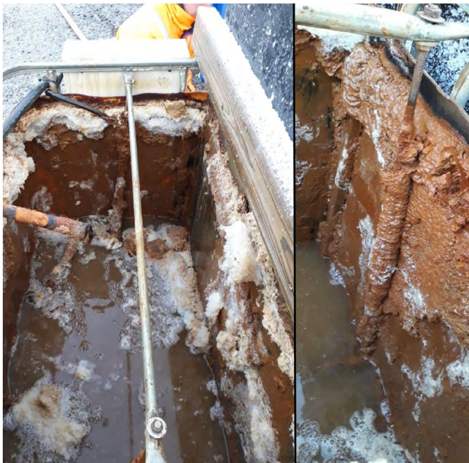
KUVA 5. Ilmastusaltaassa havaitut sakkamäärät sekä niiden pinttyminen altaan reunoille ja hapettimen kiinnittimiin (kuva Aki Mykkänen).
