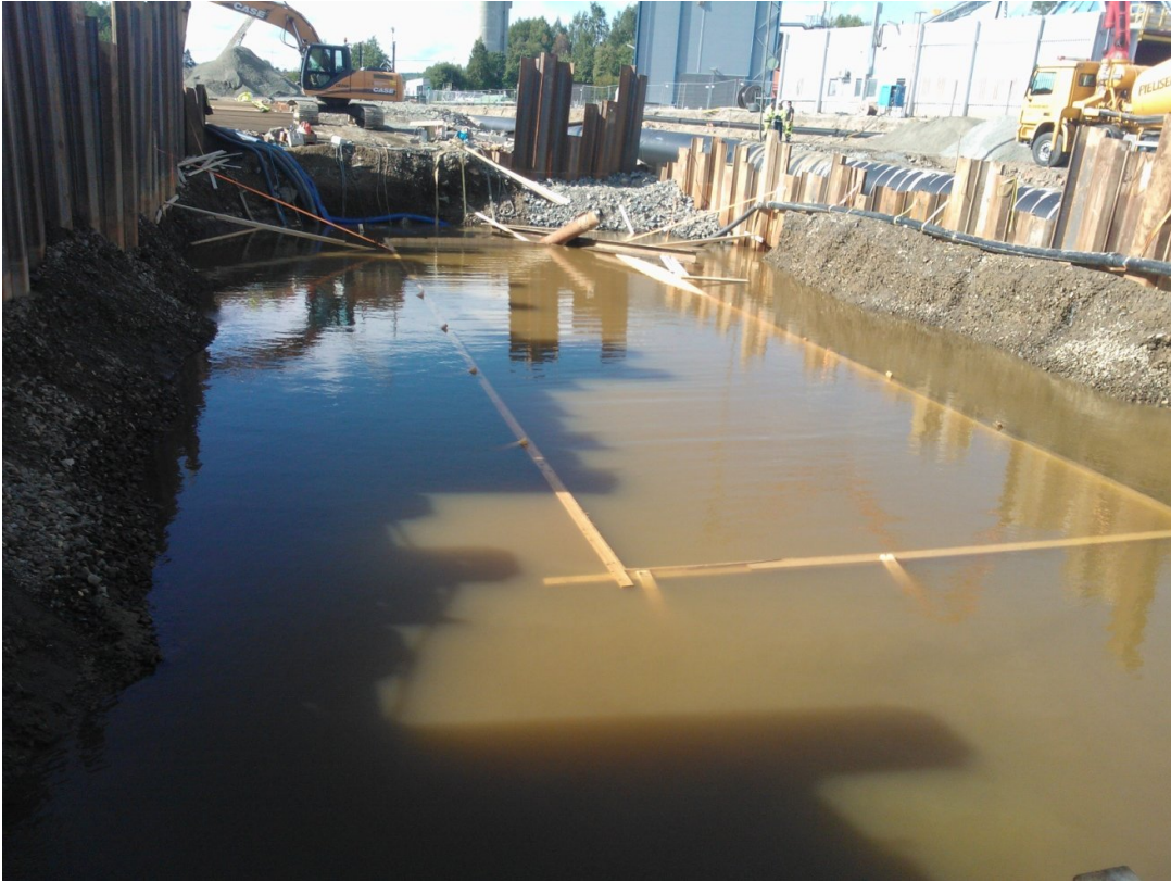
Kuva 13. Pumput sammuneet. (Männikkö 2012–09–05)
