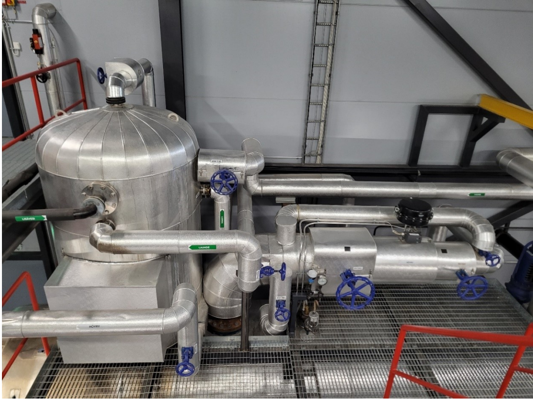
Kuva 4. Kaasunpoistin Artukaisten laitoksella.
