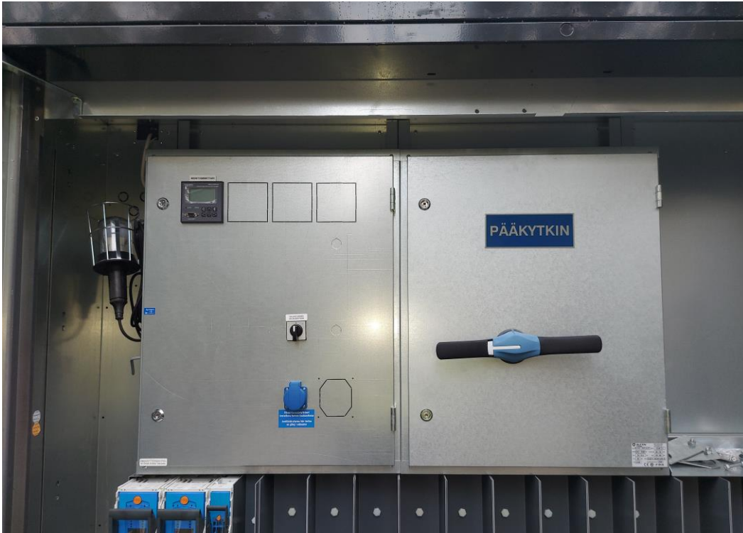
Kuva 13. Wimo asennettuna PJ-keskukseen (TESV Oy).
