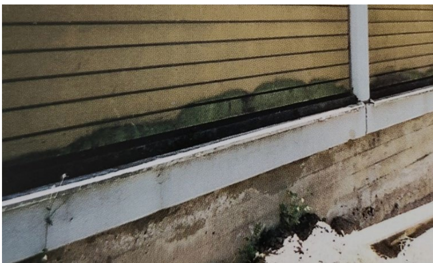
Kuva 2. Penicillium -hometta rakennuksen ulkoseinässä. Home ja terveys s.25
