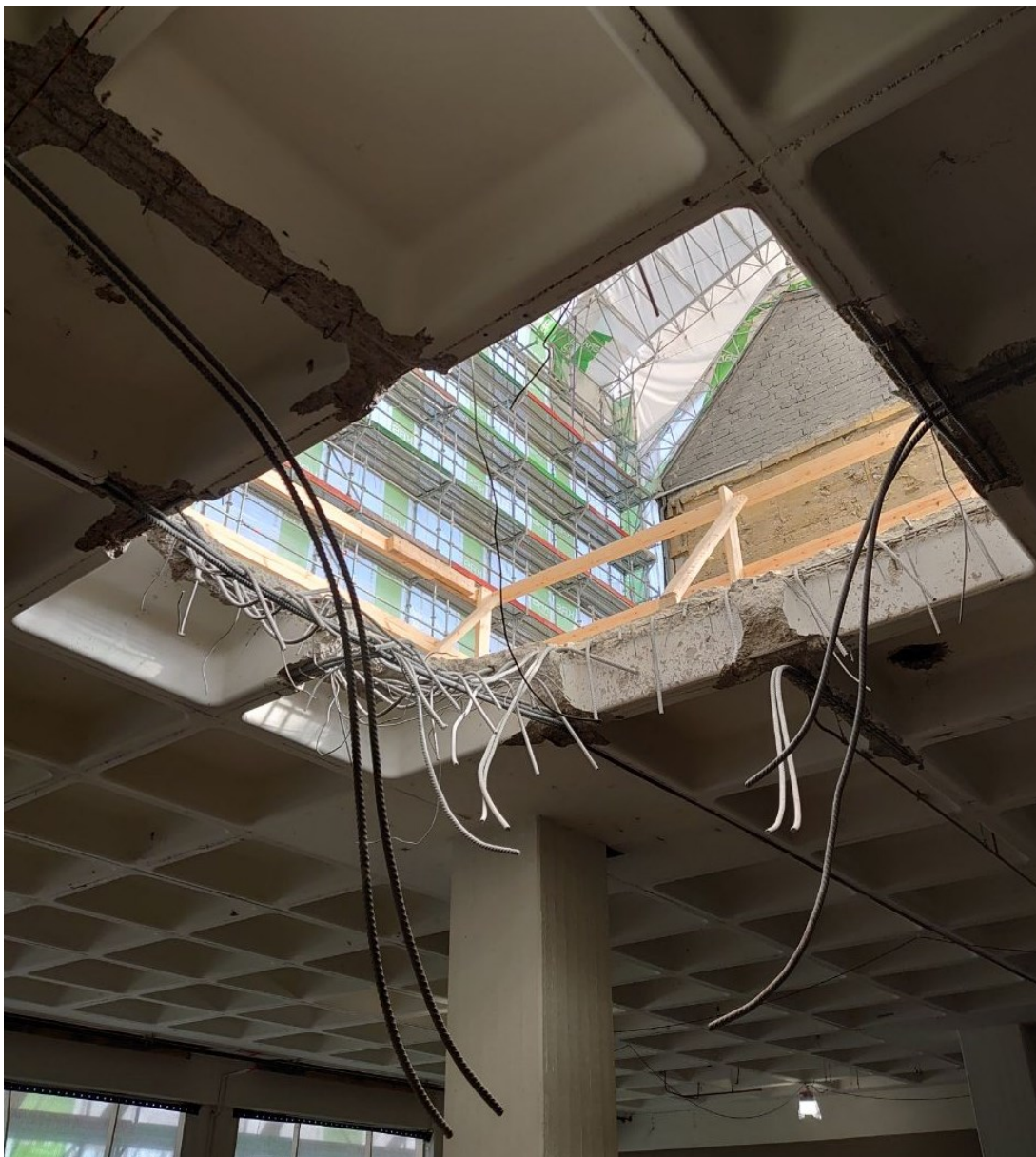
Kuva 17. Purkujätteen pudotusaukko ennen korjaustöiden aloitusta. Kuva on otettu
