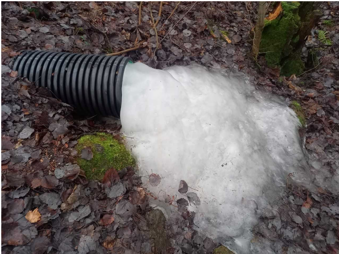
Kuva 3 Jää voi tukkia rummun ja johtaa vakaviin tien kuivatusongelmiin lumen sulaessa keväällä.
