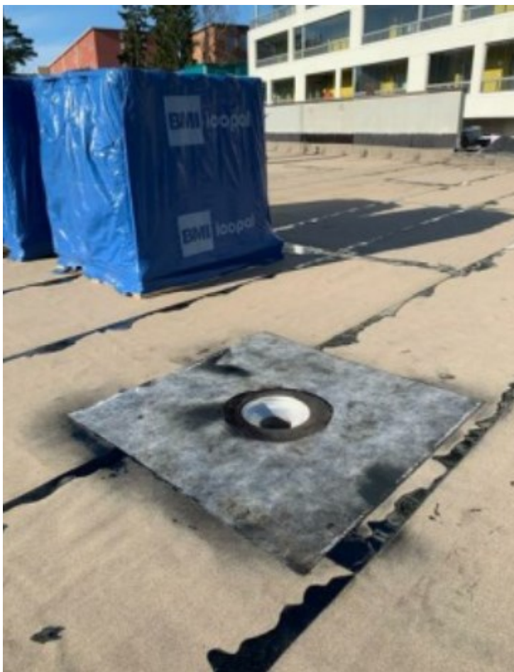
Kuva 10. Kaivoon hitsattu bitumilaippa (Kuva: Samuli Viitala)
