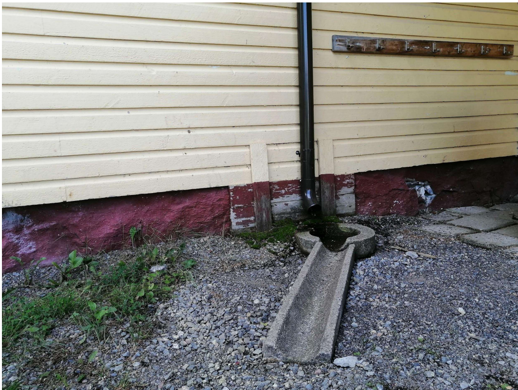
KUVA 16. Konnuslahden koulun perustukset ja sokkelirakenteet ovat huoltomaalauksen tarpeessa
