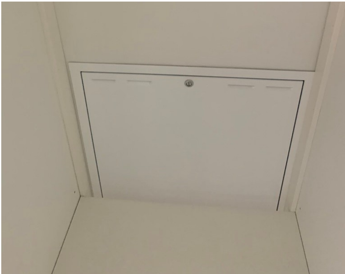
Kuva 7. Jakotukkikaappi kaapiston takaseinään integroituna. Kuva: YIT.
