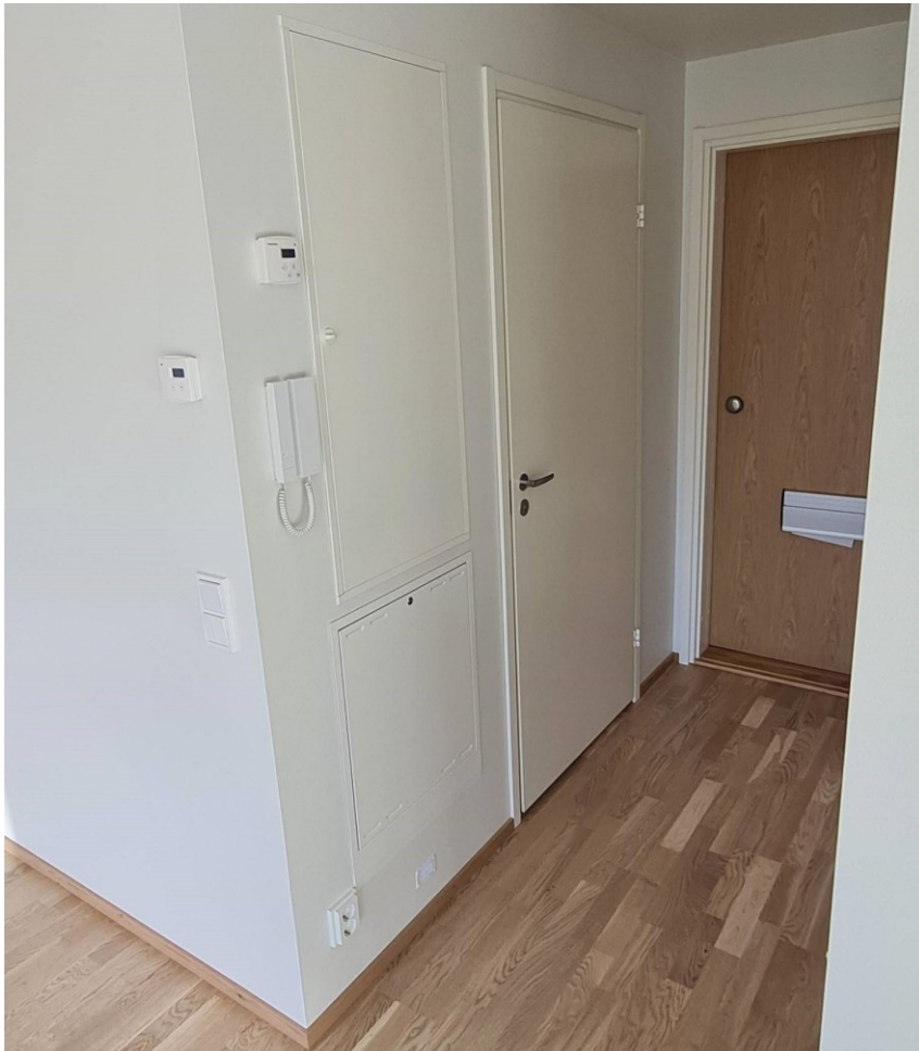
Kuva 6. Jakotukkikaappi integroituna väliseinään sähkökeskuksen kanssa. Kuva YIT.
