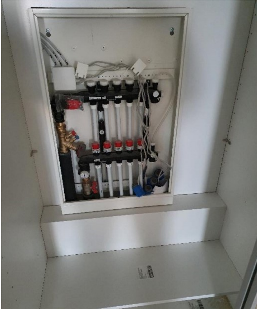
Kuva 5. Kaapiston takaosaan koteloimalla asennettu jakotukkikaappi. Kuva: YIT.
