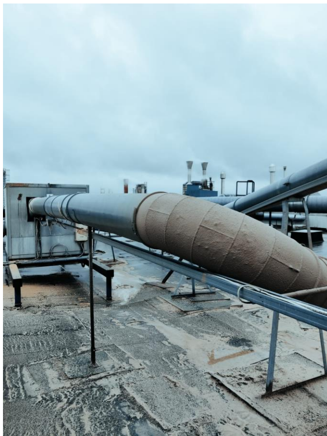
Kuva 7. Eristetty hakkeensiirtolinjan 90° mutka.
