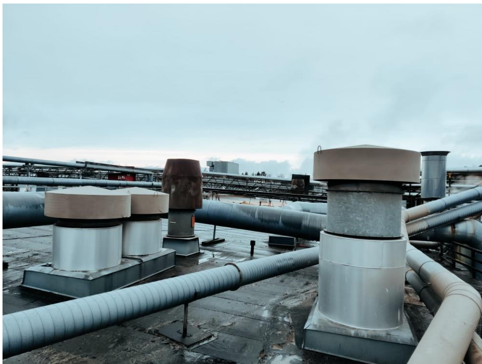
Kuva 6. Puhaltimien hatut eristettynä massalla.
