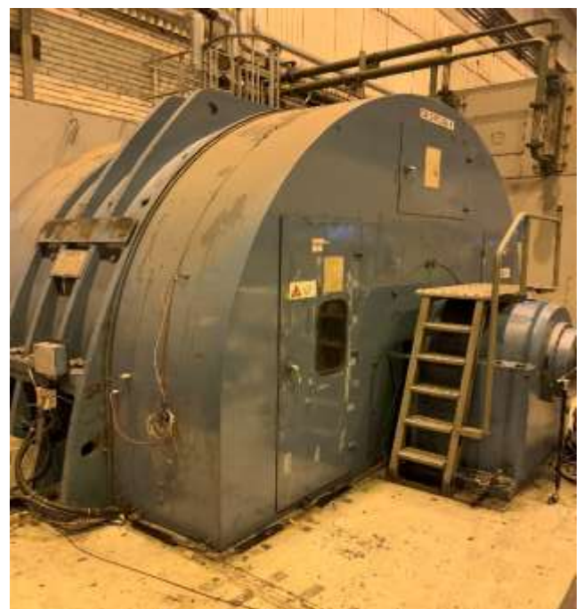
Valssituolin F4-päämoottori suojaelitteineen
