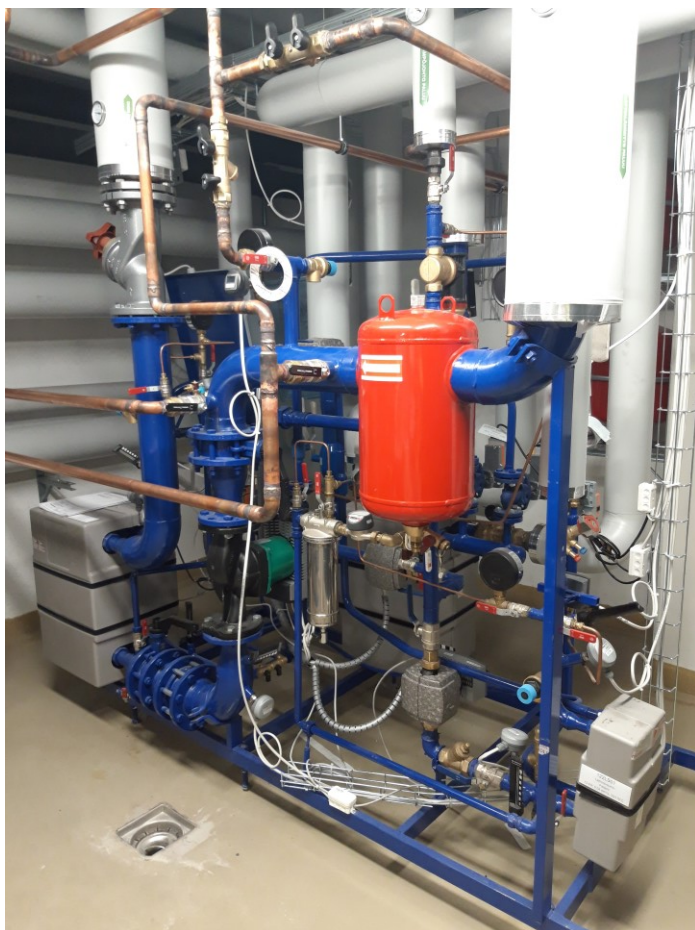
Kuva 2. Kaukolämmön alajakokeskus kohteen lämmönjakohuoneessa.
