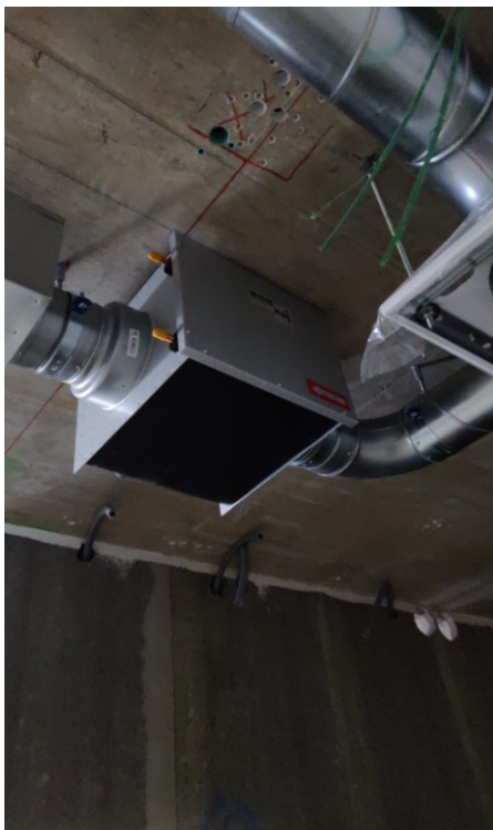
Kuva 3. Esimerkkikuva kohteeseen asennetusta jäähdytyspatterista tuloilmakanaviston väliin.
