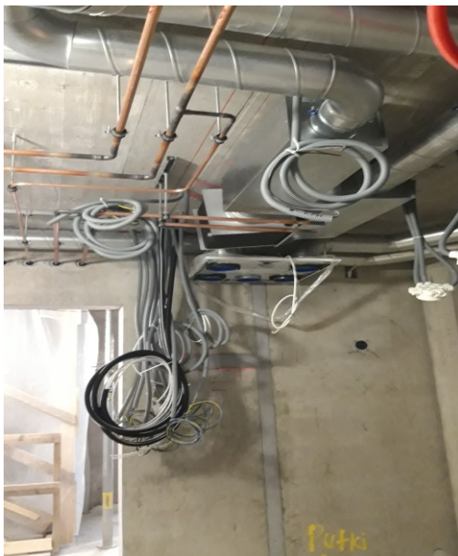
Kuva 4. Kuva asunnosta olevista putkista
