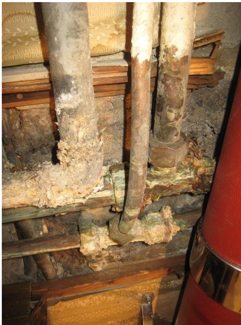
Kuva 6. Kiinteistön vuotavia vesijohtoliitoksia. (MAH Isännöinti Oy)
