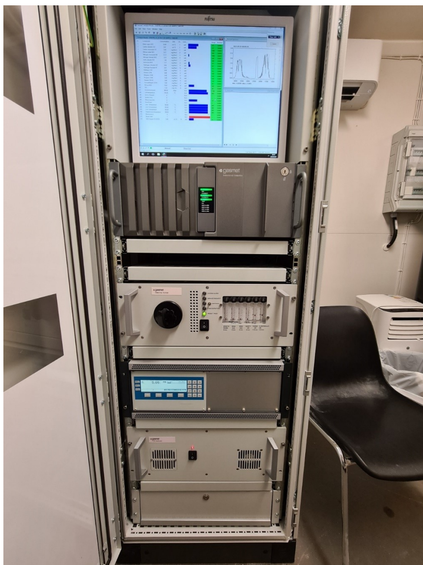
KUVA 10. Uusi asennettu ja käyttöönotettu päästömittausjärjestelmä (Selyunin 2021.)
