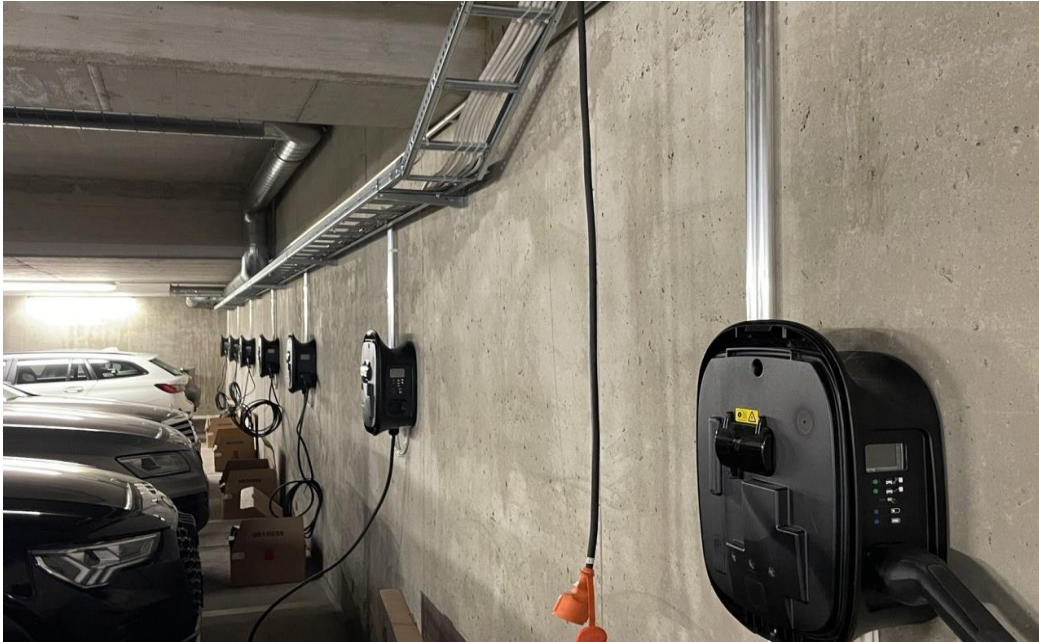
KUVA 15. Latausjärjestelmän kaapelointi pysäköintihallissa
