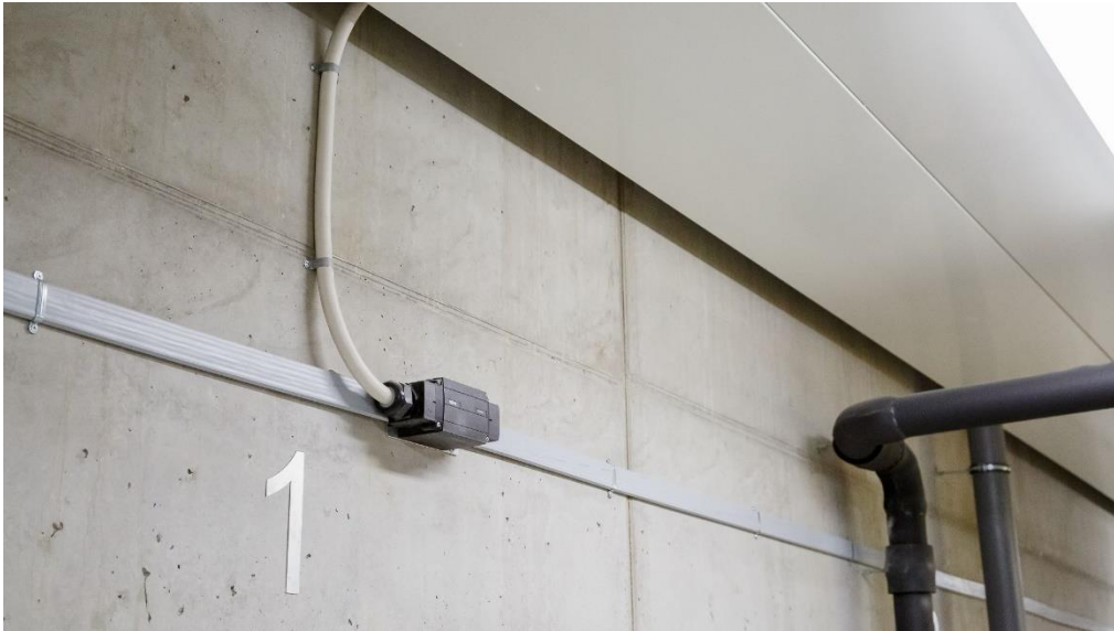
KUVA 16. Lattakaapeli ja väliottomoduli asennettuna betoniseinälle (22)
