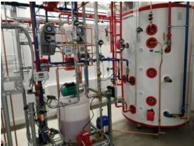
Aurinkokeräinten kiertojärjestelmät ja energiavaraaja (Leskelä 2021)
