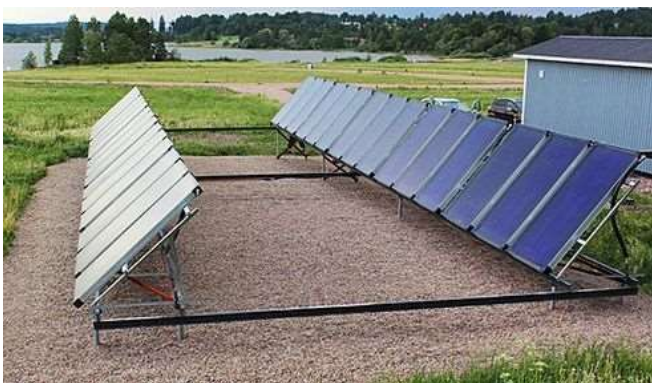
Aurinkokeräinten sijoittelussa tulee huomioida rakennuksista, puista tai toisista keräimistä aiheutuvat varjostukset (Motiva 2020)
