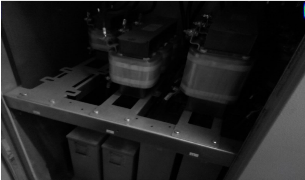
Kuva 21. Akustisella kameralla kuvattu kompensointilaitteisto.
