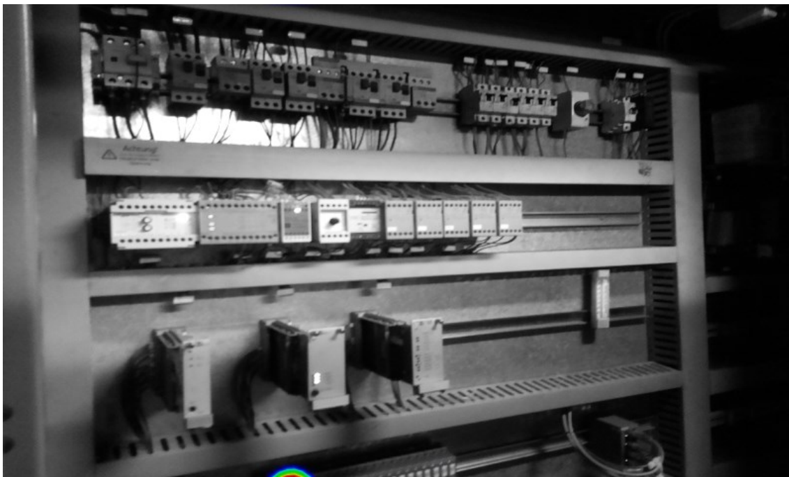
Kuva 17. Akustisen kameran kuva sähkökeskuksesta.
