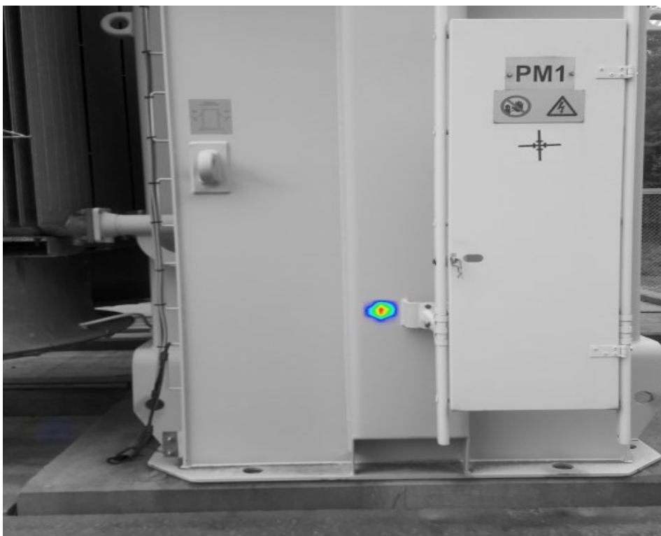
Kuva 13. Äänilähde muuntajan kotelossa.
