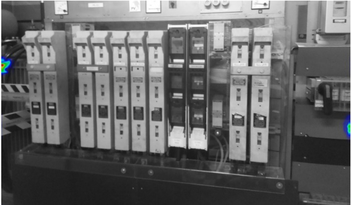
Kuva 19. Akustisen kameran kuva 400 VAC:n jonovarokekeskuksesta.
