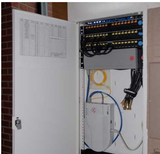
Kuva 14: ONU asennettuna sähkökaappiin (www.thefoa.org)
