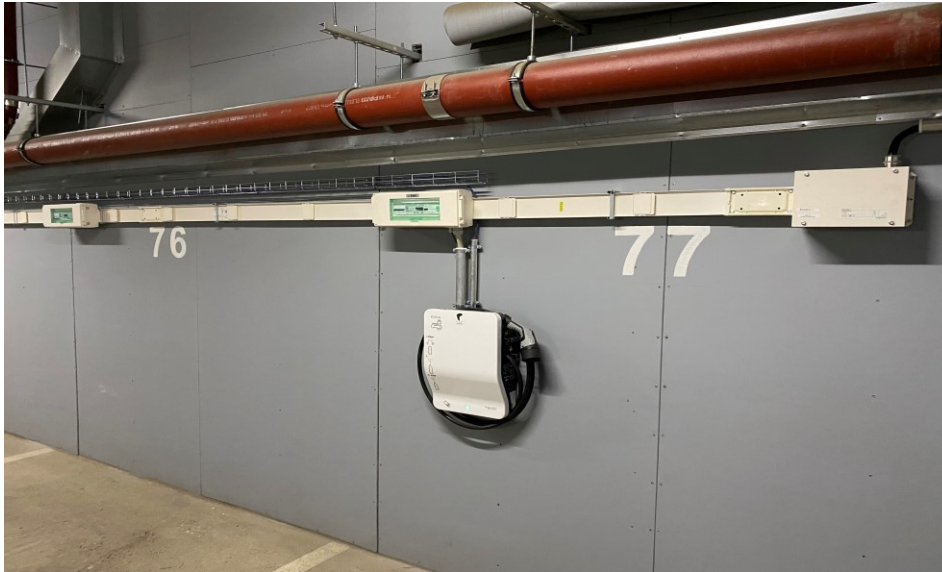
Kuva 16. Canalis-virtakiskojärjestelmään asennettu Smart Wallbox.
