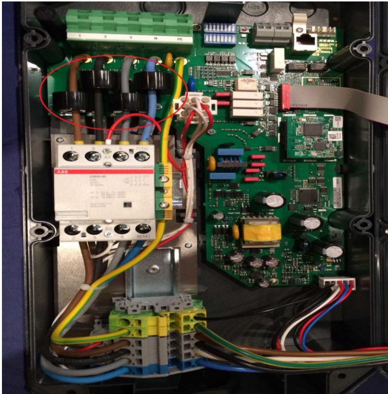
Kuva 17. Latausasemaan sisäänrakennettu energiamittaus virtamuuntajilla. [47.]
