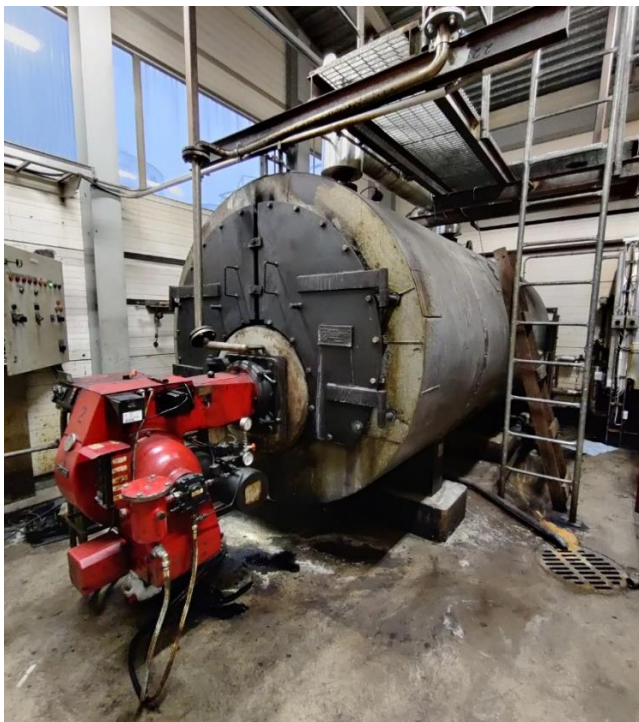
Kuva 2. Kirrinsannan jätteenkäsittelylaitoksen öljypoltin ja -kattila. (Kuvaaja: Heidi Lähteenmäki)
