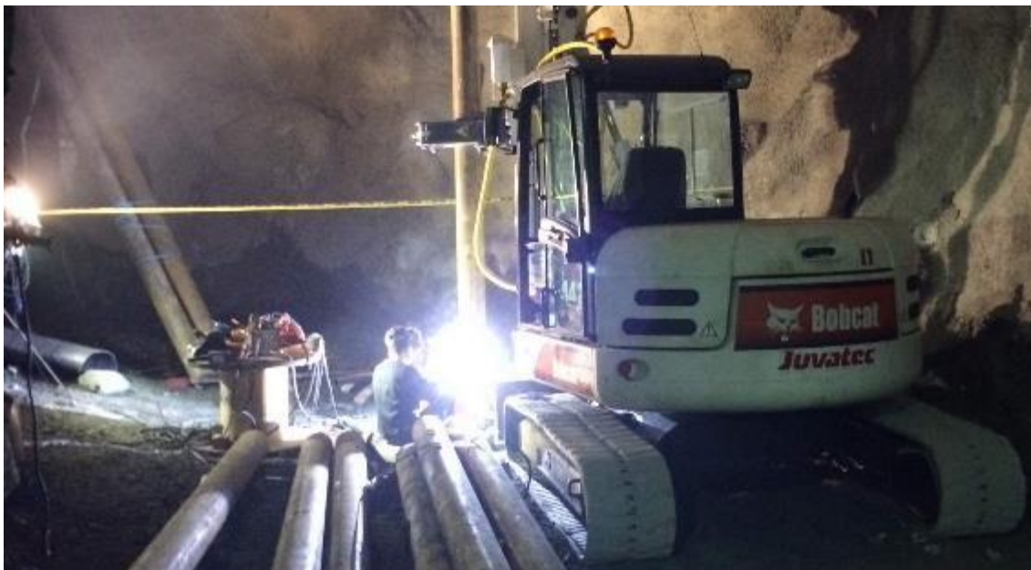
Kuva 12 Aliurakoitsijan Pasilan asemalla käyttämä porapaalutuskone. Kuvassa kone ei ole töissä Pasilan asemalla. (Juvatec)
