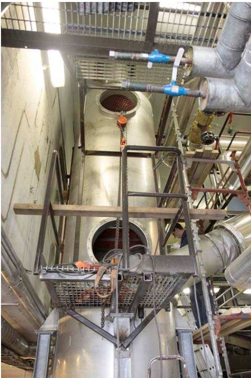
KUVA 14. Puolangan kunnan savukaasupesuri
