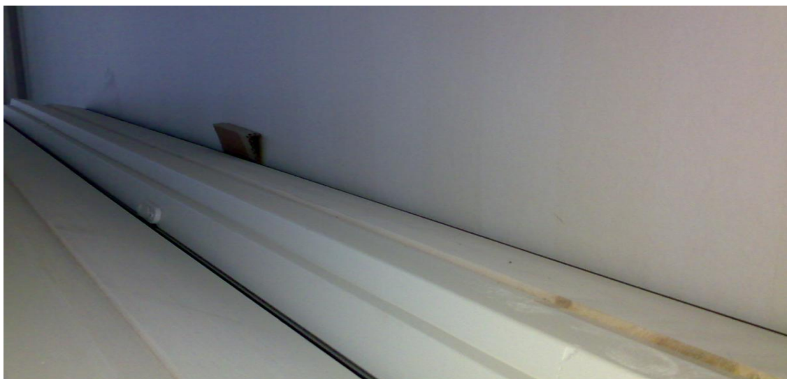
Kuva 24. Korjauskohteissa kaikkia pintoja ei aina uusita. Kuvassa säilytettävää tapettiseinää vasten on varastoitu parvekeovi- ja ikkunanippu ilman kunnollista suojausta, mikä altistaa molempien pinnat vaurioitumiselle (Kuva Kimmo Anttonen).
