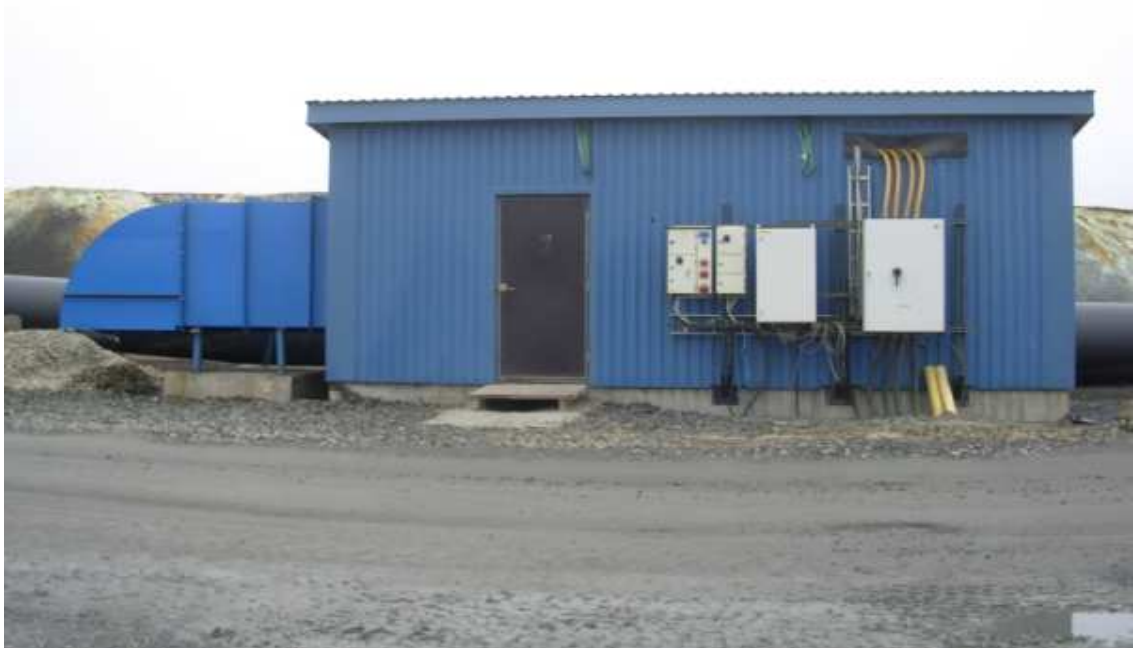
Kuva 6. Puhallinkoppi betonisella alustallaan.
