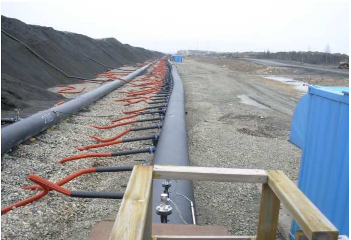
Kuva 8. Malmikasan alle menevät ilmaputket.
