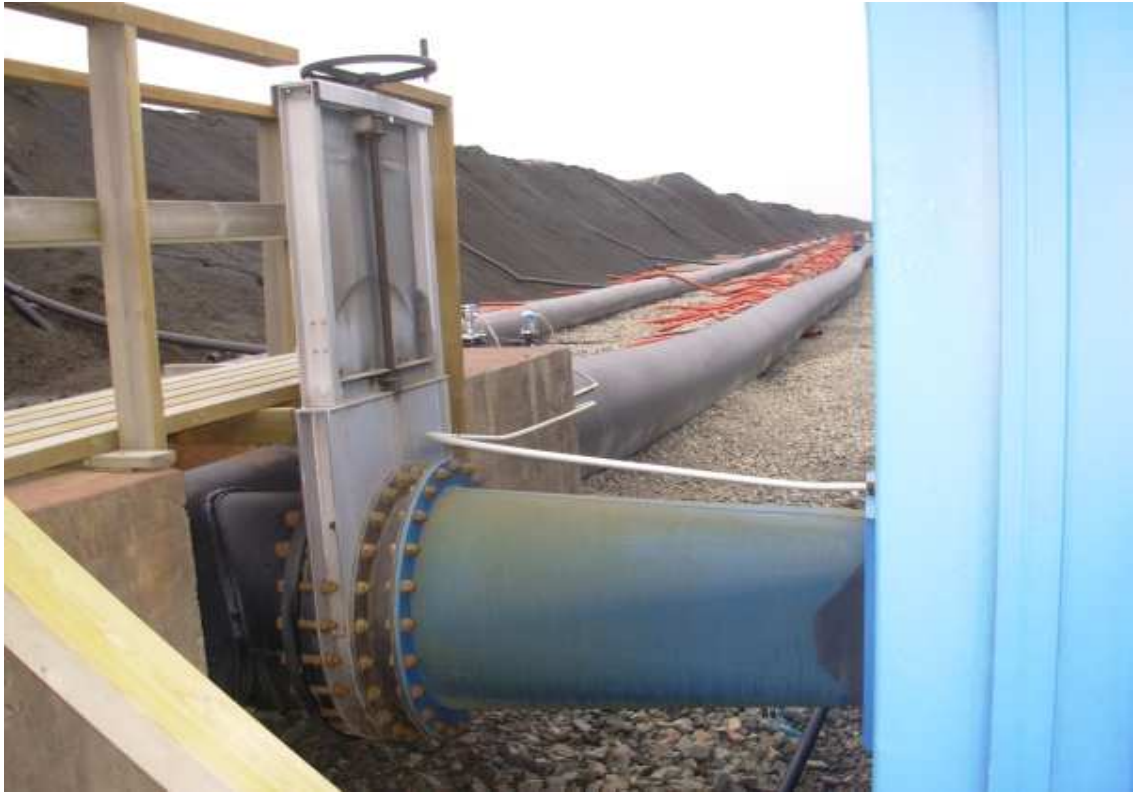
Kuva 7. Puhaltimen liittyminen runkoputkeen ja levyluistiventtiili.
