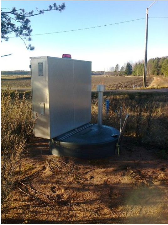
Kuva 14 Länsikylän-Myllykylän vesihuolto-osuuskunnan pumppaamo (Pulkkinen 2013).
