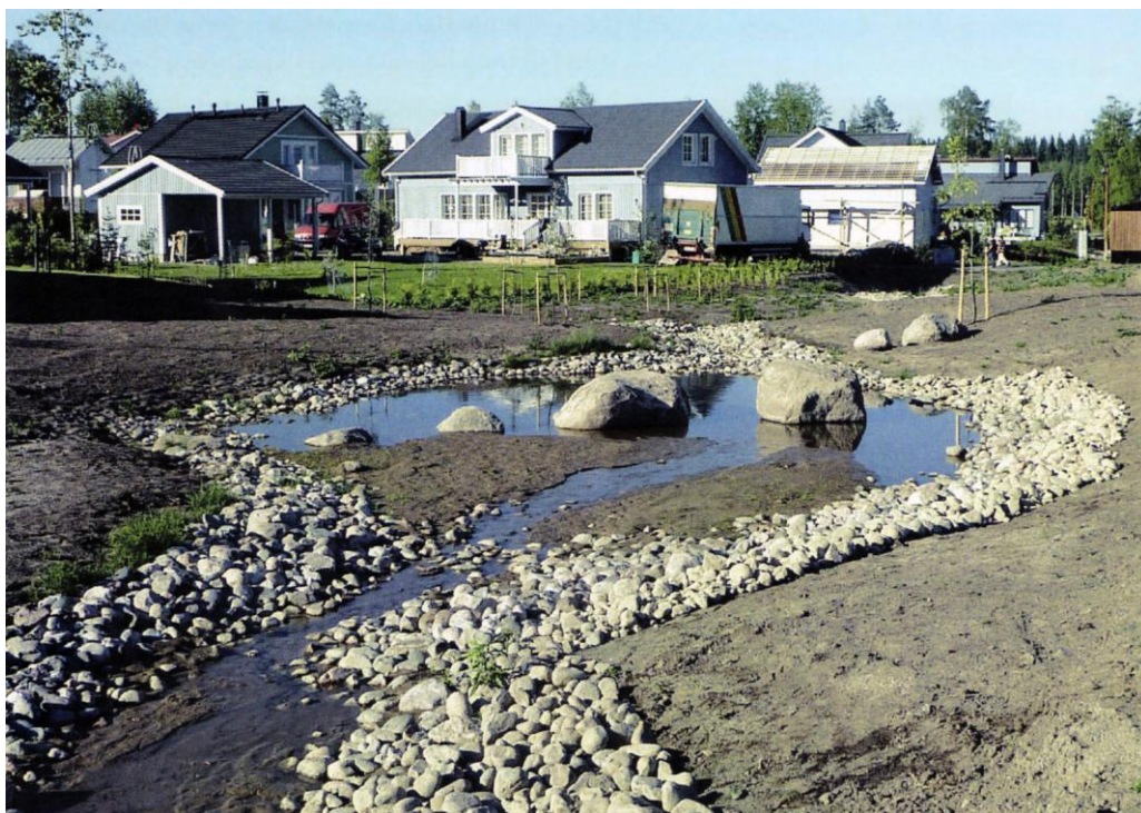
KUVA 6. Vastarakennettu avoin huleveden johtamisjärjestelmä Karistossa vuonna 2010 (Malin ym. 2010, 35)
